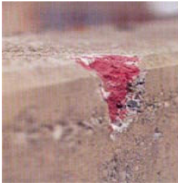
Foto 27. Carbonatación sobre una grieta fresca.
