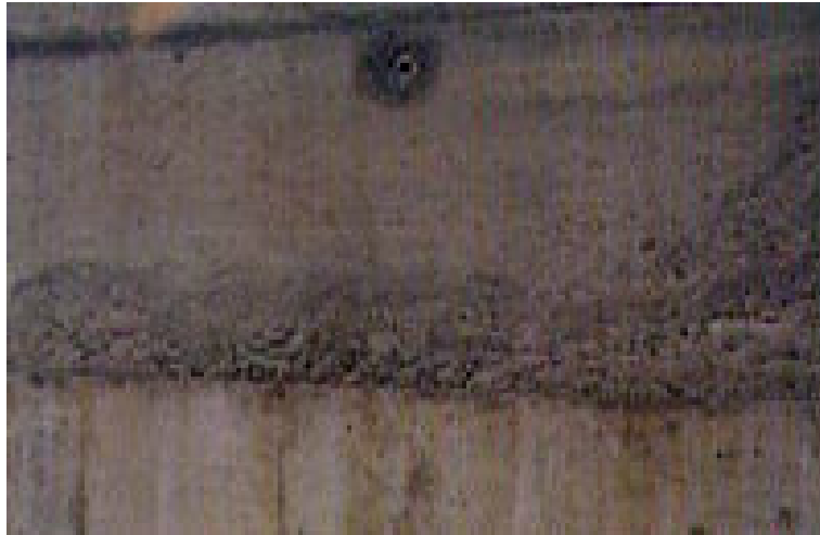
Foto 20. Nidos de abeja formados como consecuencia de una altura de caída excesiva, o también por una armadura muy densa
