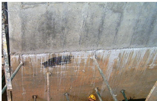
Foto 29. Eflorescencia sobre un muro en hormigón
