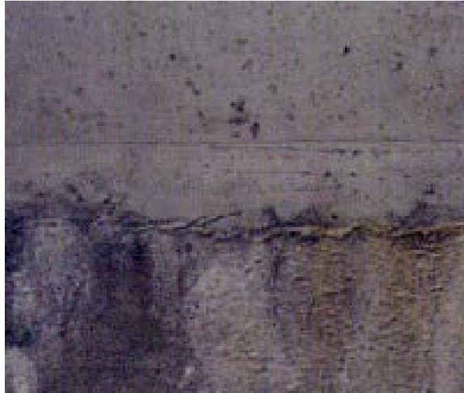
Foto 30. Si el hormigón es poroso y el agua penetra en él constantemente, las eflorescencias se transforman en condensaciones calcáreas.
