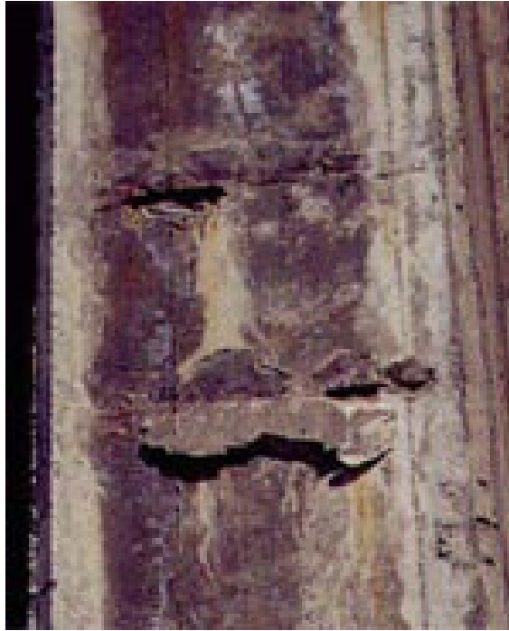
Foto 28. El frente de carbonatación alcanza la armadura , a causa del óxido que se forma en ésta , su volumen aumenta y el hormigón se fisura y disgrega.
