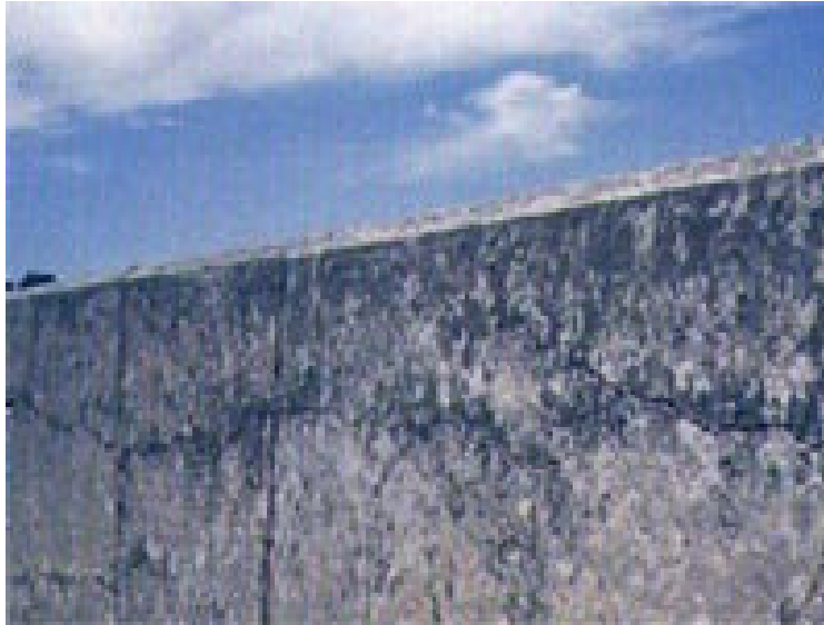
Foto 31. La fisuración intensa visible como consecuencia de la hinchazón del hormigón causada por la reacción álcali-agregado
