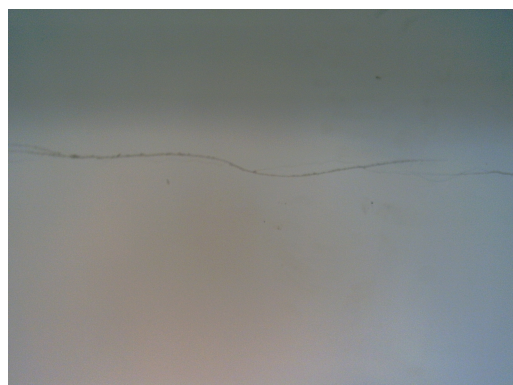
Foto 25. Fisuras de contracción de un muro
