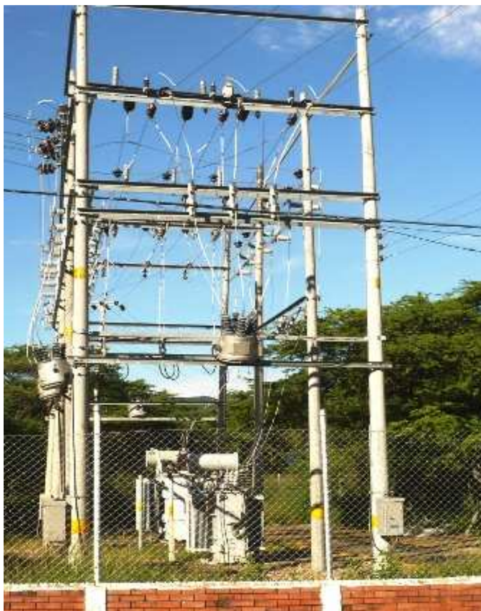
Figura 6. Subestación Típica 34.5 kV - 6 MVA, Municipio de Apulo.
