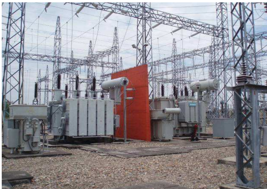
Figura 4. Subestación Flandes 115 kV / 34.5 kV Capacidad 65 MVA
