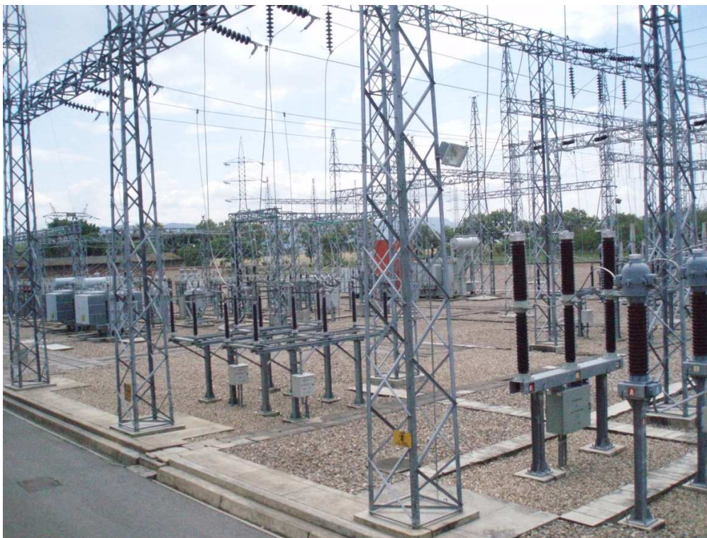
Fuente: Subestación Flandes 115 kV.
