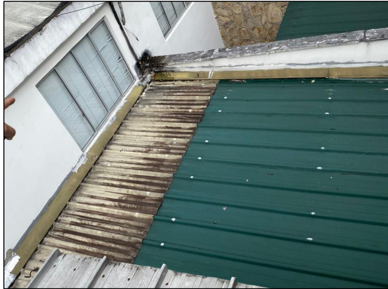
Figura 11 Estado Actual Cubierta En Teja Transparente
