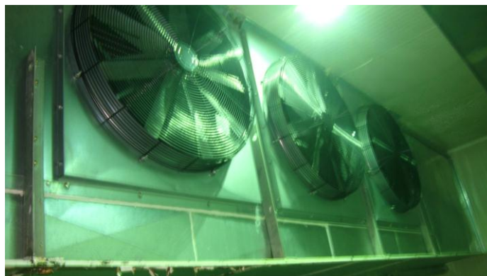
Figura 31. Evaporador en cuarto de congelamiento
