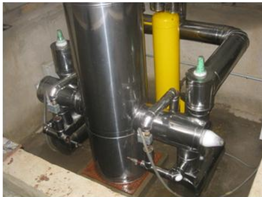
Figura 34. Bombas de amoníaco
