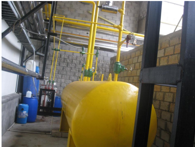
Figura 40. Tanque receptor de alta presión
