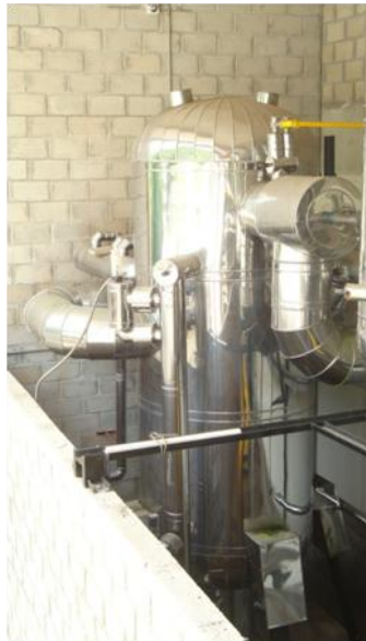
Figura 33. Tanque de separación
