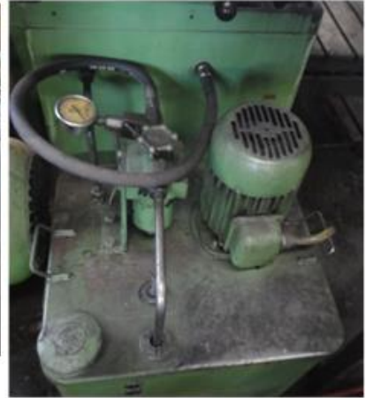
Motor eléctrico y accesorios hidraulicos
