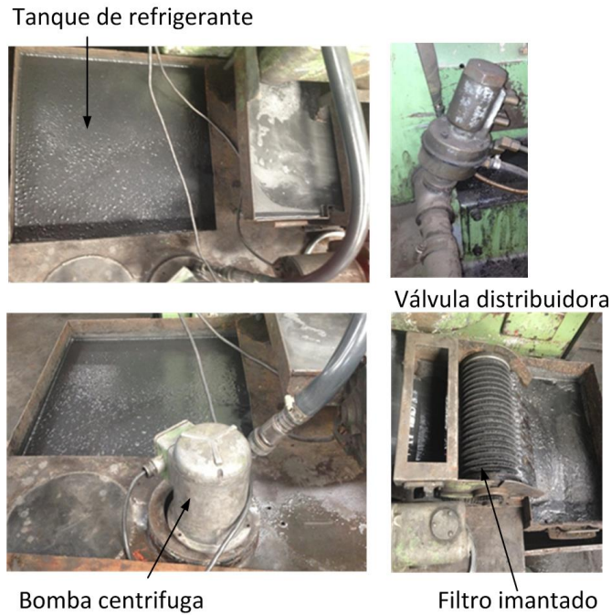
Figura 62. Componentes del subsistema hidráulico de refrigerante
