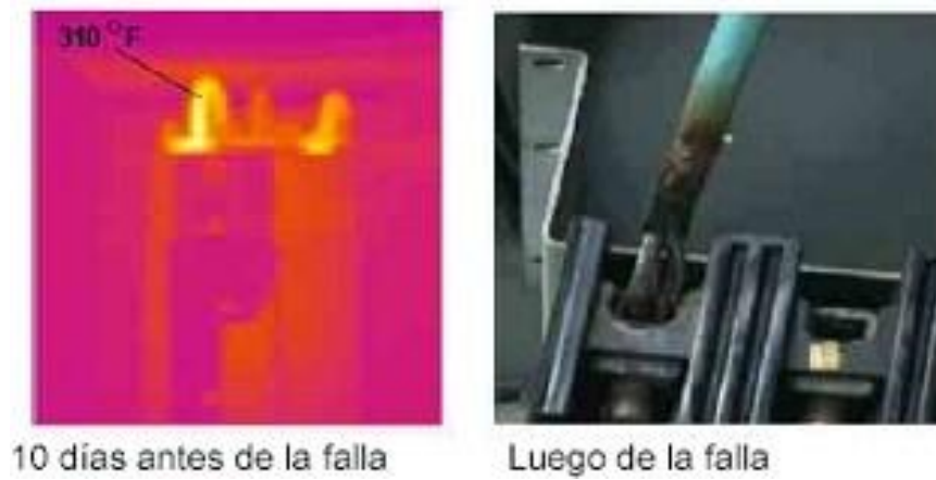
Figura 7. Detección de problema en interruptor magnético.
