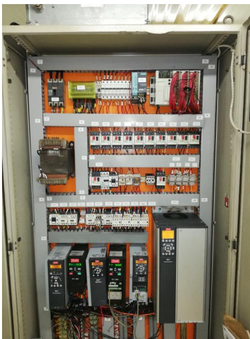
Figura 36. Sistema fuerza y control.
