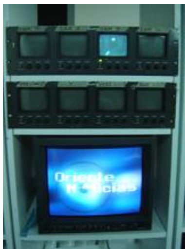
Figura 47. Cuarto de control 21
