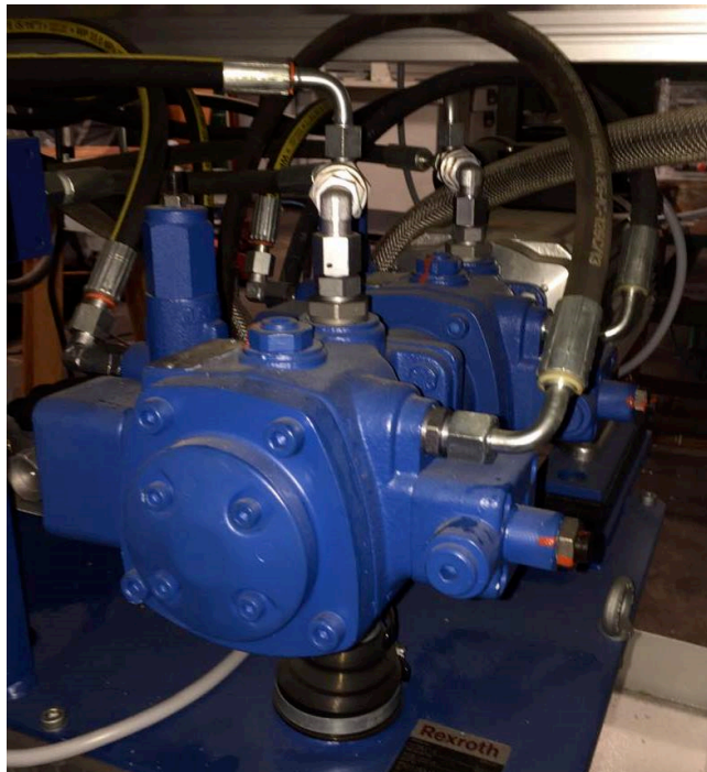
Figura 2. Unidad de bombeo del banco Rexroth.
