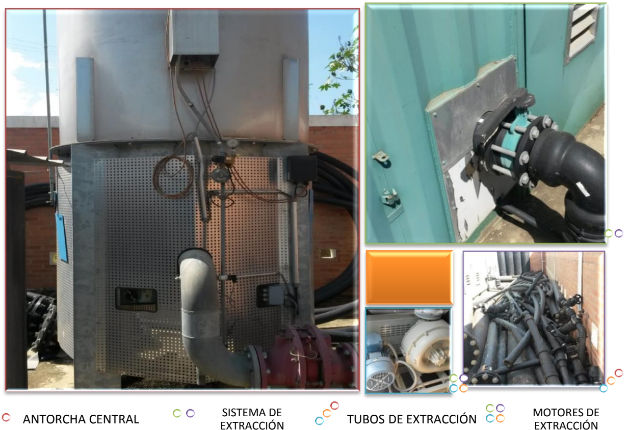
Figura 18. Elementos dejados por BIONERSIS en el Relleno Sanitario “El Carrasco”.
