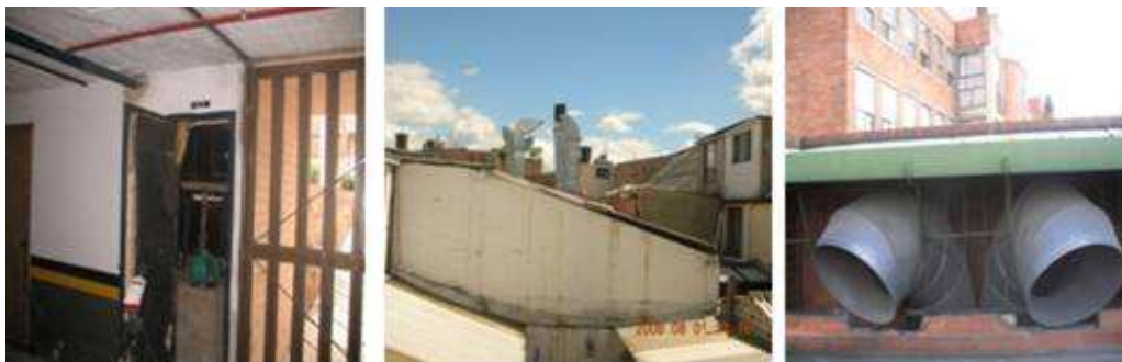
Figura 48. Contaminación sonora proveniente de los sistemas de extracción y ventilación.
