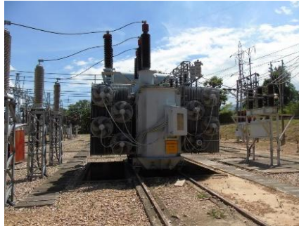
Figura 2 Transformador sub. Los Palos
