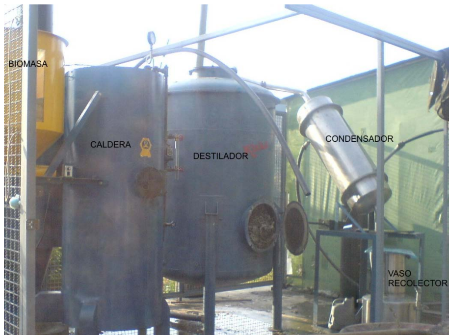
Figura 9. Caldera de biomasa.
