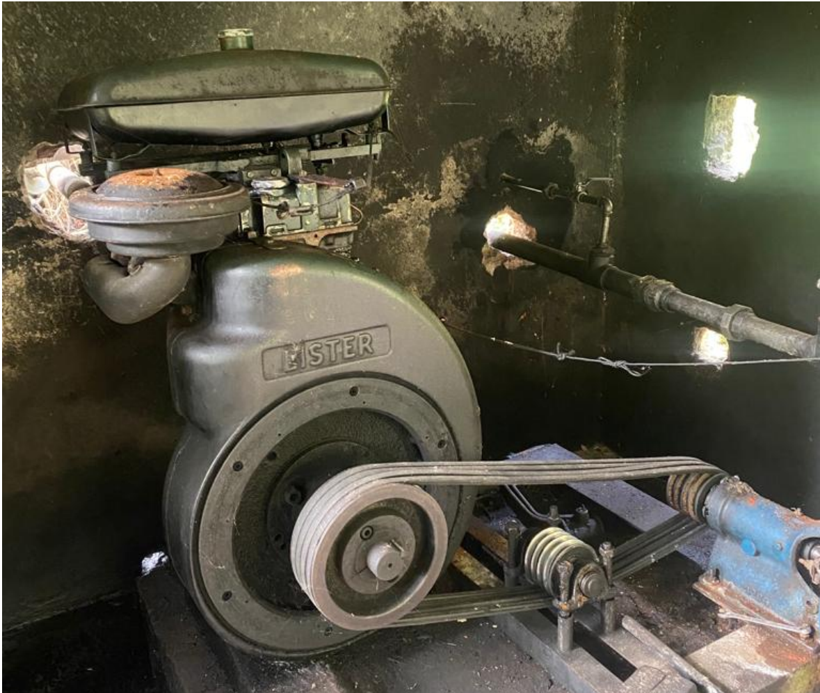
Figura 21. Cuarto de Bombeo Bocatoma La Pavita.
