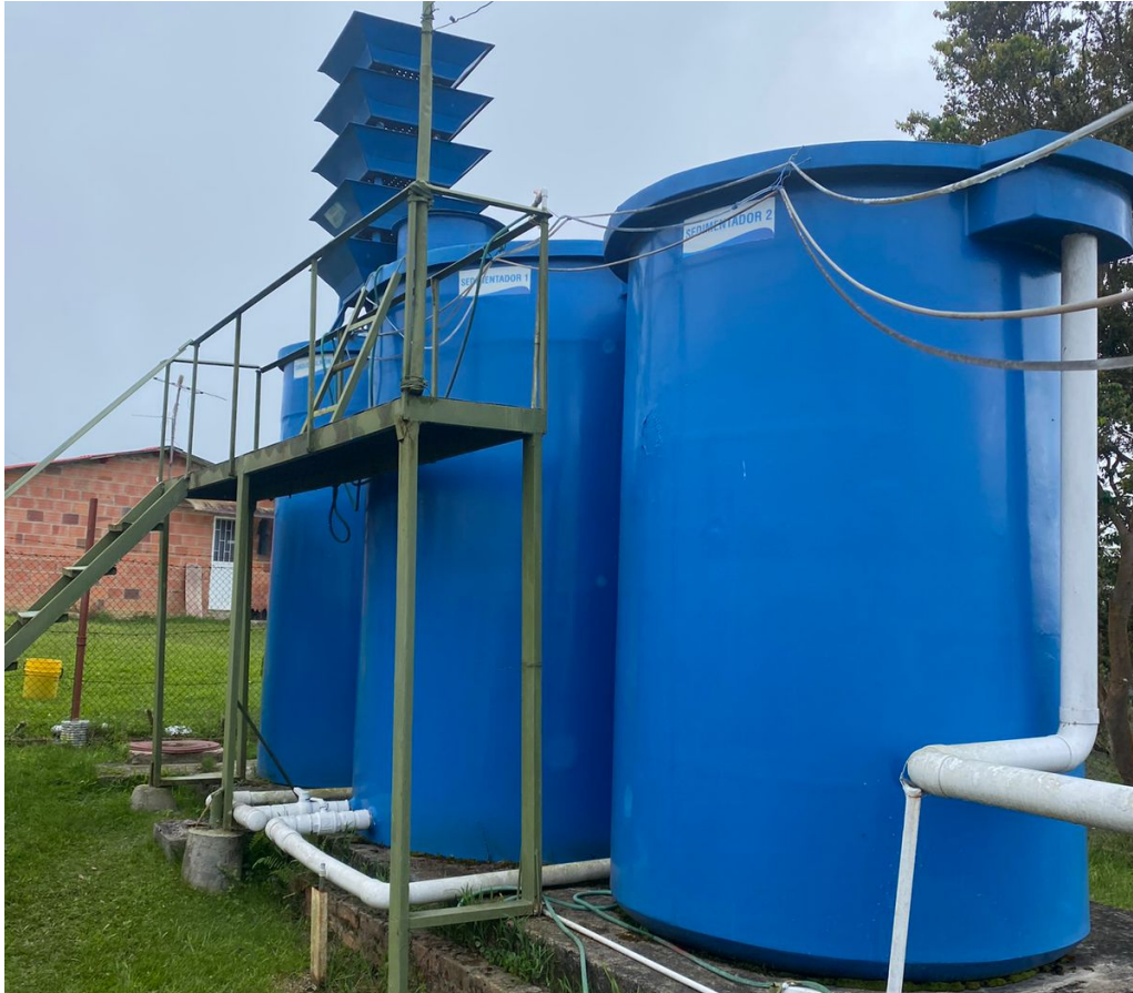
Figura 17. PTAP Actual acueducto casco urbano del municipio.
