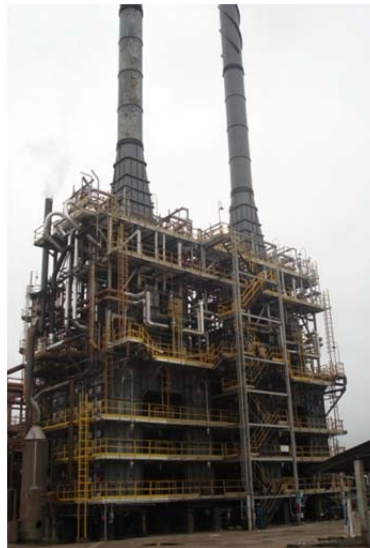
Figura 13. Horno industrial petroquímico de pirólisis de etano para producción de etileno.
