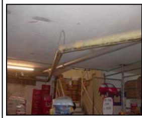
Imagen 22. Tuberías de la sucursal Comercio
