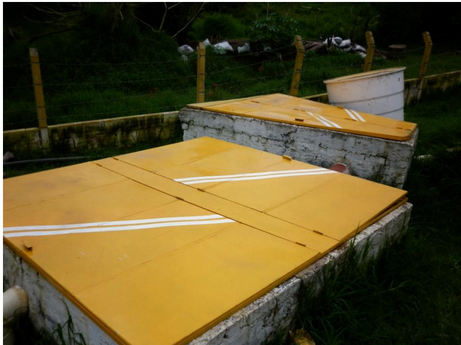
Figura 10. Tanque de Decantación y Sedimentadores del Sistema de Tratamiento de Aguas Residuales (Fuente: Autores)
