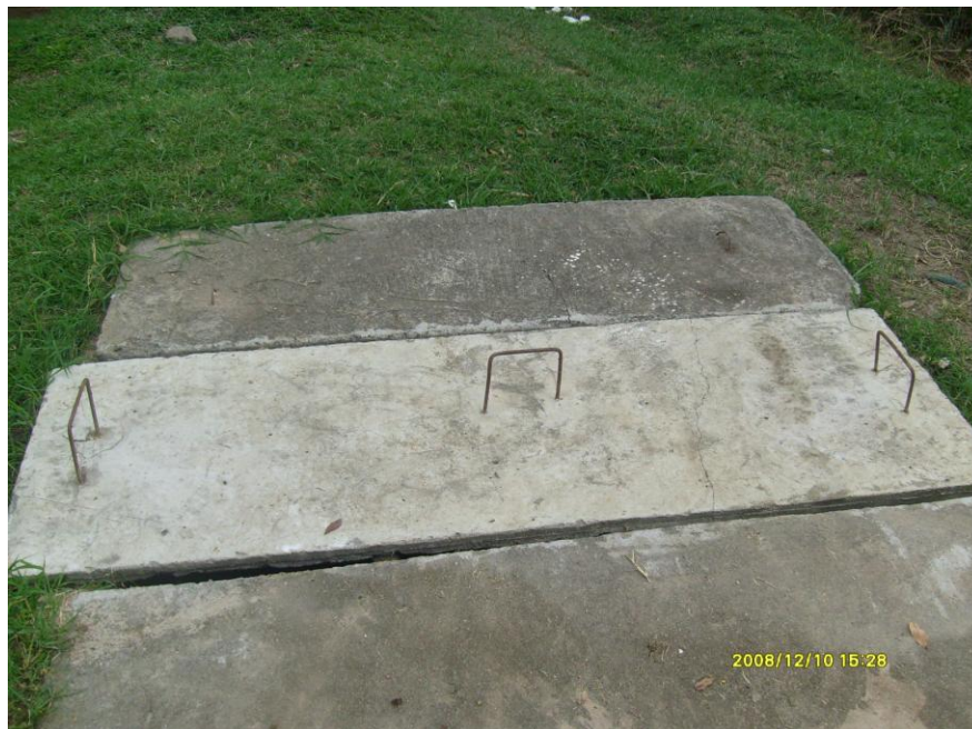
Figura 9. Entrada al Sistema de Tratamiento de Aguas Residuales (Fuente: Autores)
