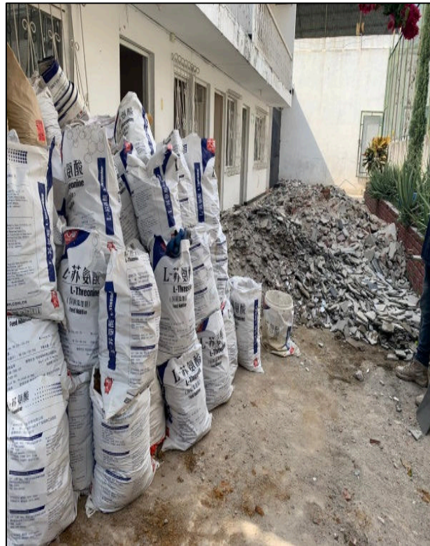
Figura 4. Registro fotográfico de ejecución de trabajos en el proyecto de remodelación de cuatro apartamentos en el colegio Americano en Bucaramanga.
