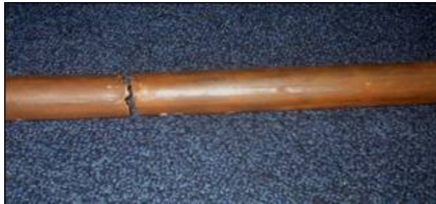
FIGURA 42. Foto de la sarta que falló en el pozo # 68.
