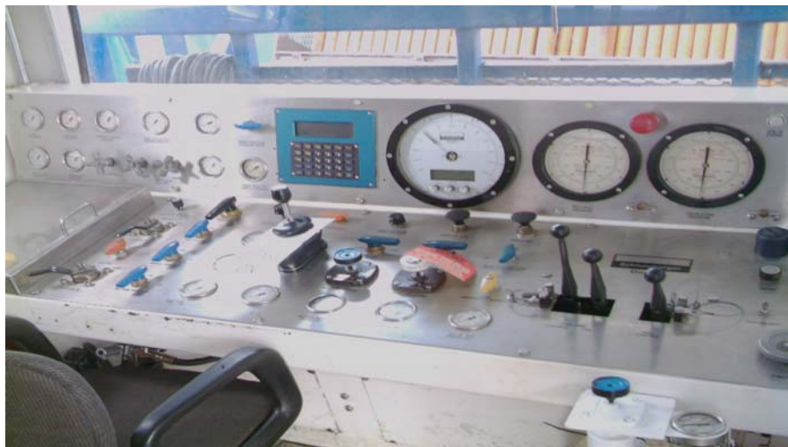
FIGURA 9. Cabina de control actualmente utilizada en los Campos Cusiana-Cupiagua.
