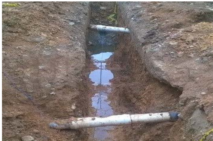
Figura 7. Tuberías de agua potable en la zona de trabajo
