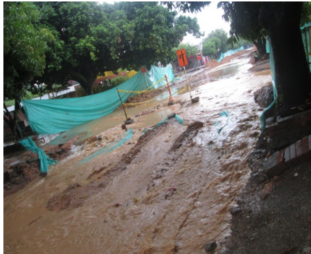
Figura 12. Inundación zona de trabajo por lluvias.
