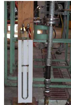
Figura 12. Platina de orificio instalada.
