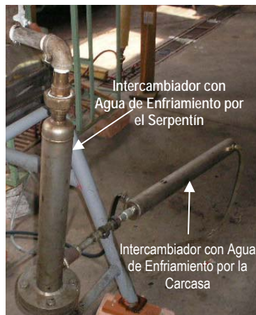
Figura13. Sistema de Enfriamiento de la planta piloto
