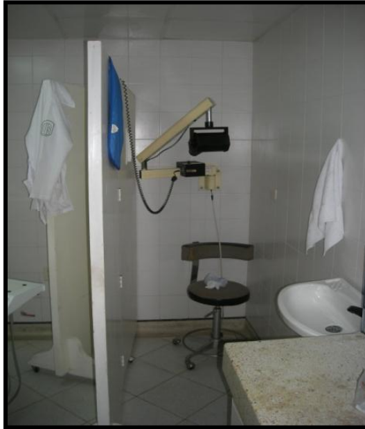
Foto 14. Instalaciones para la toma de rayos “X”
