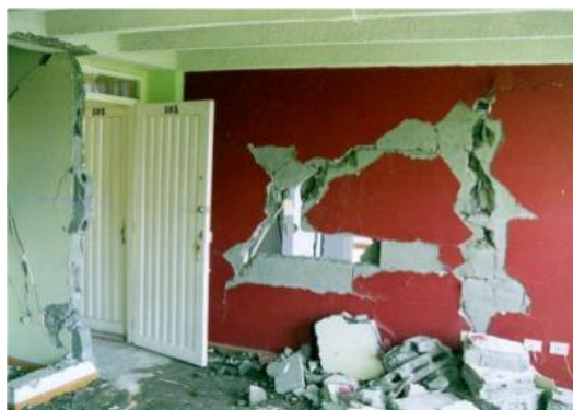
Ilustración 5 Daño Severo en muros divisorios. tomado de Guía Técnica para la Inspección de edificaciones después de un Sismo.
