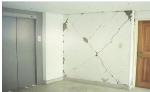
Ilustración 4 Daño Moderado en muros divisorios. tomado de Guía Técnica para la Inspección de edificaciones después de un Sismo.
