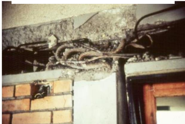
Ilustración 11 Daño severo en nudos. tomado de Guía Técnica para la Inspección de edificaciones después de un Sismo.
