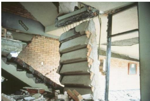
Ilustración 6 Daño Severo en escaleras. tomado de Guía Técnica para la Inspección de edificaciones después de un Sismo.
