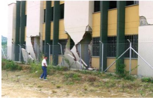
Ilustración 2 Daño Severo. tomado de Guía Técnica para la Inspección de edificaciones después de un Sismo
