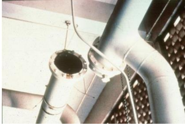
Ilustración 7 Daño Severo en Instalaciones acueducto, alcantarillado, energía y Gas. tomado de Guía Técnica para la Inspección de edificaciones después de un Sismo.
