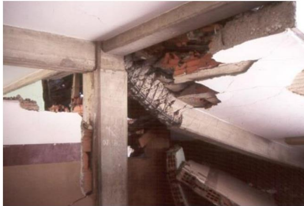
Ilustración 10 Daño severa en vigas. tomado de Guía Técnica para la Inspección de edificaciones después de un Sismo.
