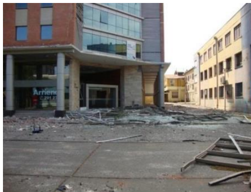
Ilustración 3 Daño Moderado en vidrios exteriores. tomado de Guía Técnica para la Inspección de edificaciones después de un Sismo
