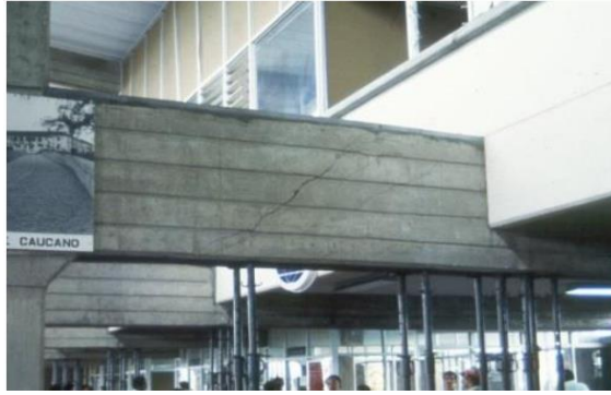
Ilustración 9 Daño Leve en vigas. tomado de Guía Técnica para la Inspección de edificaciones después de un Sismo.
