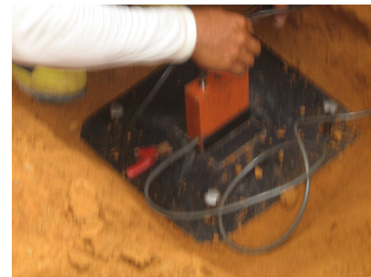
Figura 219. Instalación de Conexión Base - Densímetro Eléctrico.
