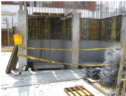
Figura 212. Demarcación de Zonas Críticas de Peligro en Obra.
