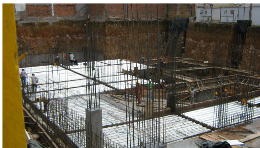
Figura 180. Instalación de Lámina en Acero para Conformación de Entrepiso en Steel Deck.
