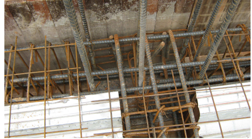
Figura 109. Detalle de Ubicación de Láminas de Acero de Losa Respecto a Otros Elementos Estructurales (Vigas, Muros, Etc.).
