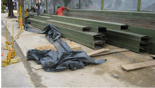
Figura 84. Almacenamiento con Inclinación sobre Bases de Madera.
