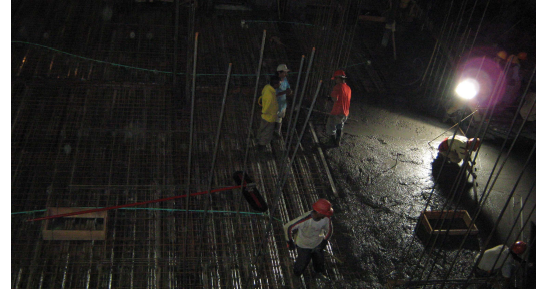
Figura 183. Nivelación del concreto de la Losa de Entrepiso en Sistema Steel Deck.
