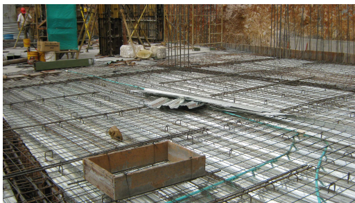
Figura 112. Esquema de Conformación Interna de Losa en Steel Deck, para Funcionamiento como Parquadero. Caja de Perforación de Losa.
