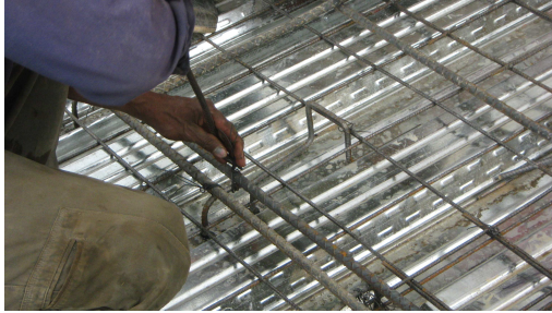
Figura 108. Instalación Refuerzo Negativo para Losa de Parquadero en Sistema Steel Deck. Refuerzo en Dirección de Viguetas por Diseño.
