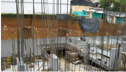
Figura 114. Acabado de Losa en Steel Deck para Parqueadero usando Llana Metálica y Helicóptero, respectivamente.
