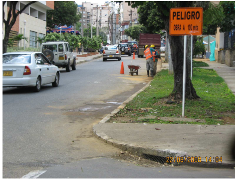
Figura 204. Limpieza de Predios Vecinos. Señalización Vial del Proyecto.
