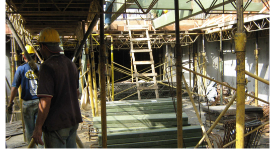
Figura 85. Almacenamiento con Inclinación sobre Bases de Madera.
