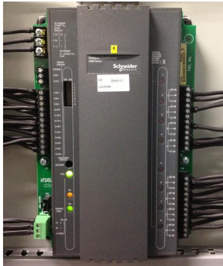
Figura 21. Conexión controladora Andover Continuum Infinet II i2800
