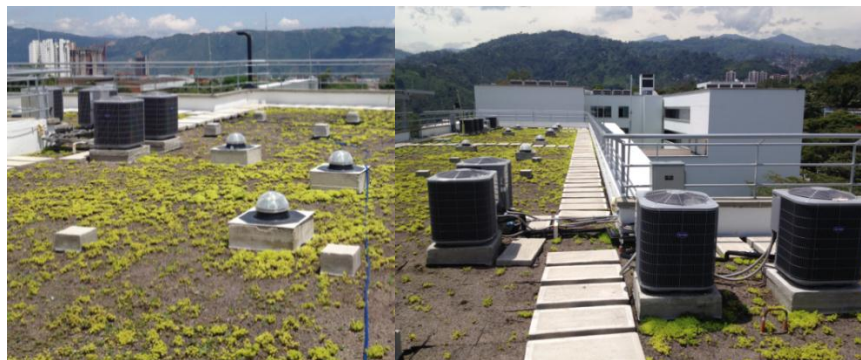
Figura 17. Techo verde y distribución de subsistema de climatización
