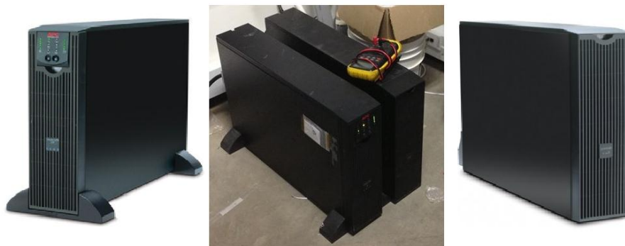
Figura 3. UPS sistema de automatización edificio E3T
