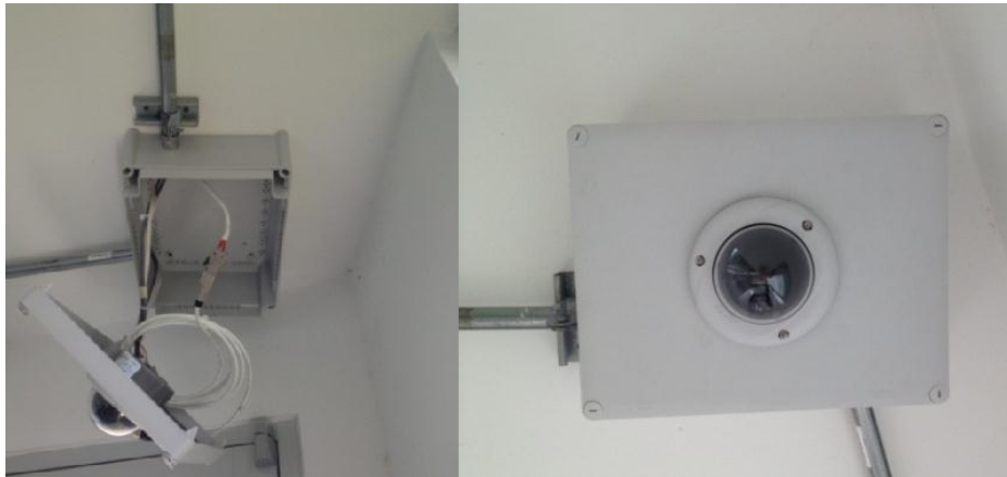
Figura 29. Cámara pasillo 5to piso
