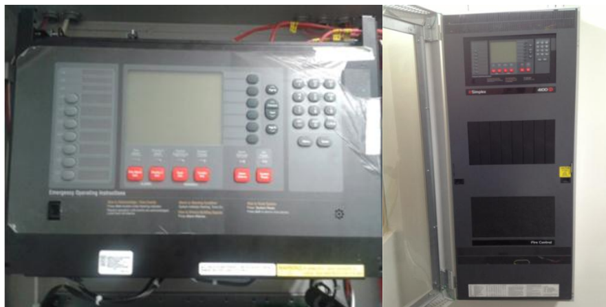
Figura 36. Panel de control de incendios (izq.). Ubicación gabinete panel de control de incendios (der.).
