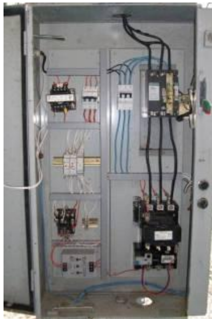
Figura 12. Control Eléctrico Convencional
