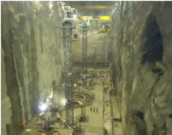
Caverna de máquinas
