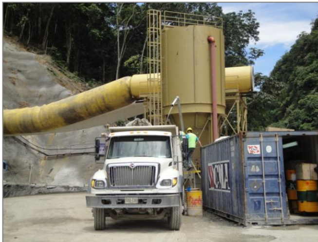
Figura 11. Sistema de ventilación en los túneles de desvío
