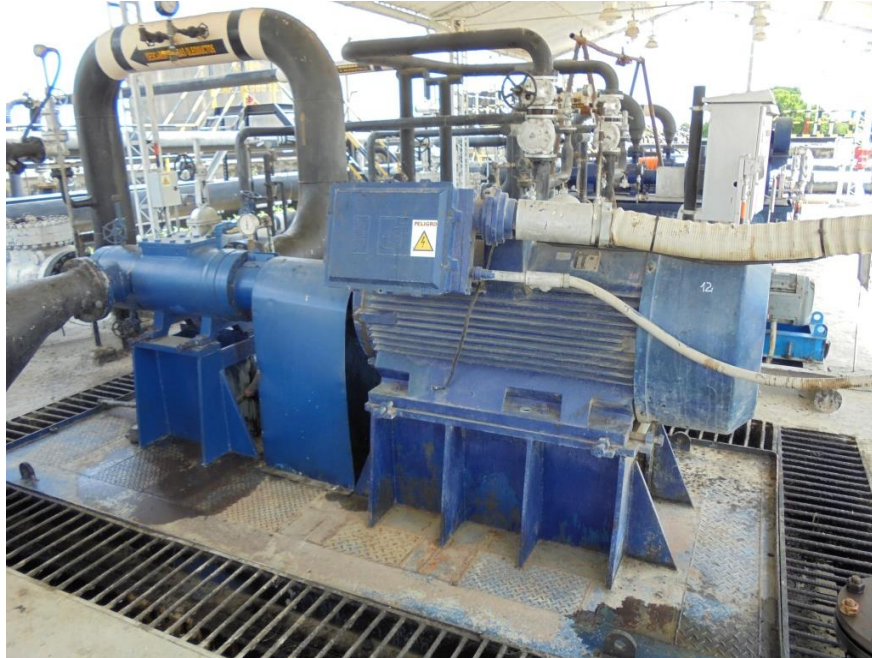
Figura 3. Unidad de bombeo oleoducto.
