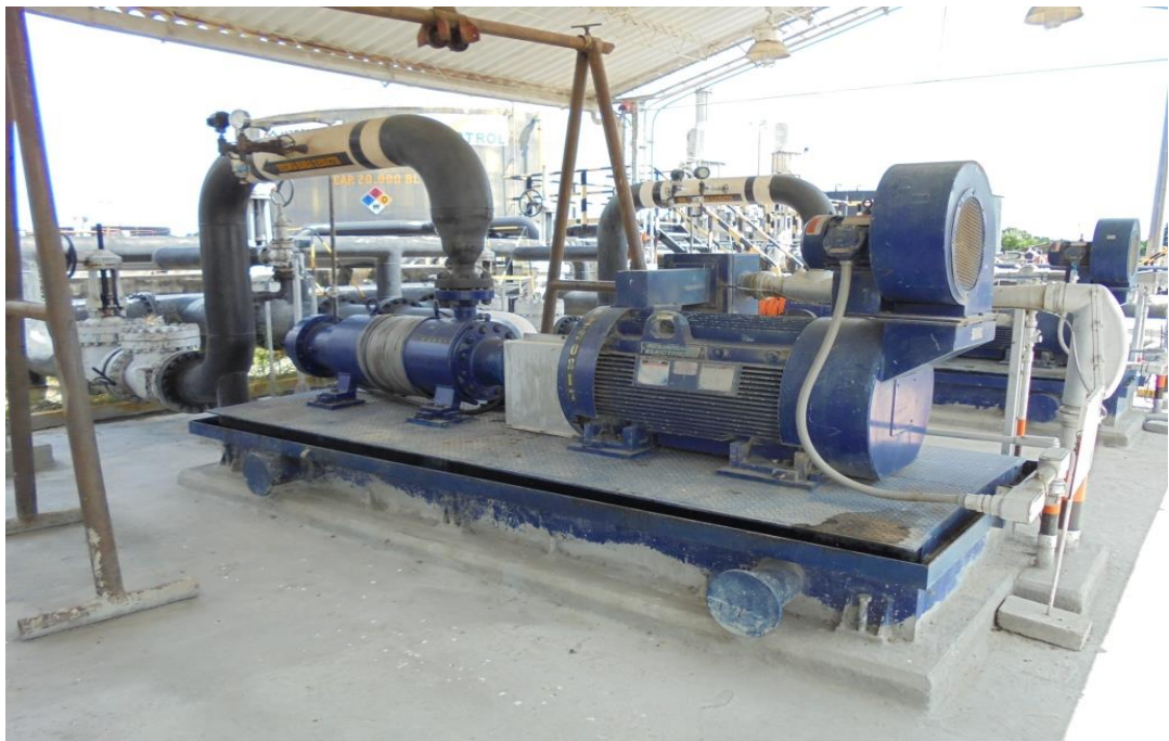
Figura 2. Unidad de Bombeo Vasconia.
