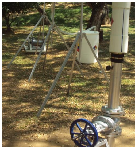
Figura 115. Conexión del sistema en zona de pruebas
