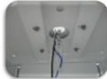
Paso de cables de Conexión del CCR
