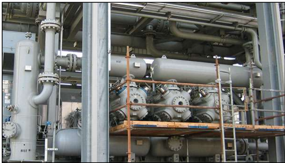
Figura 4: Unidad compresora Reciprocante
