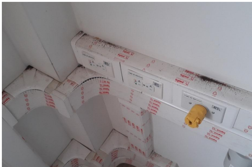
Figura 20. Suciedad en las canalizaciones
