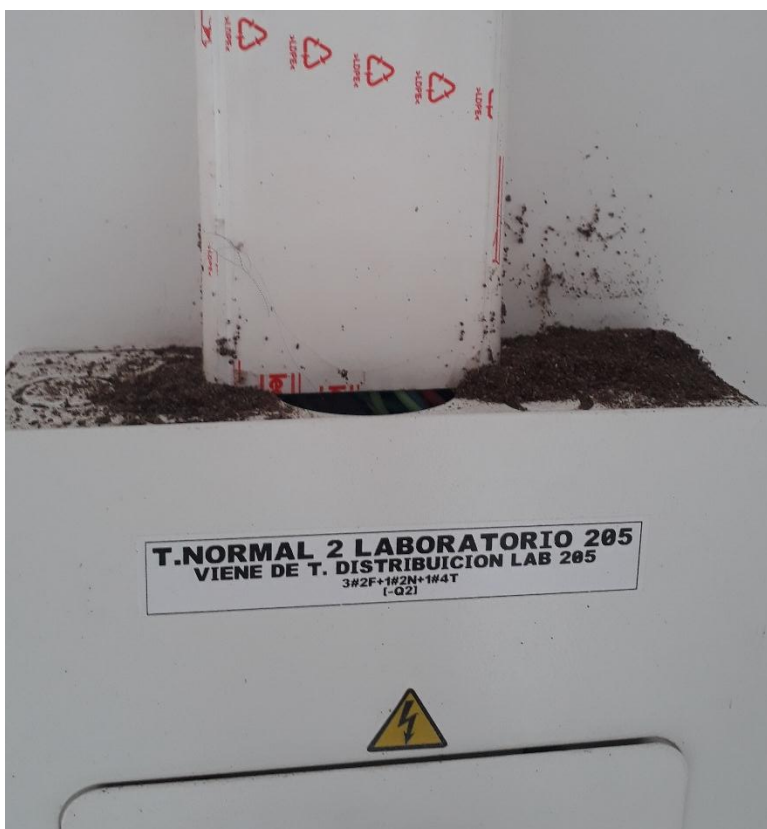
Figura 27. Suciedad sobre el tablero de distribución normal 2
