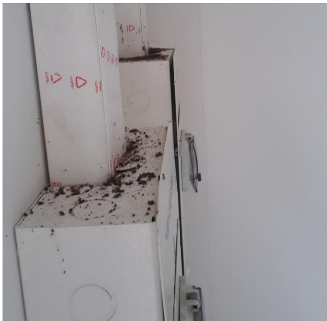
Figura 26. Suciedad sobre el tablero de distribución normal 1
