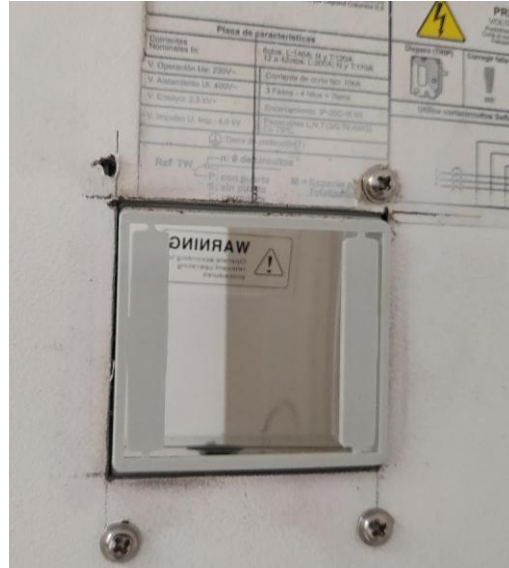
Figura 23. Tapa frontal del tablero de distribución normal 2
