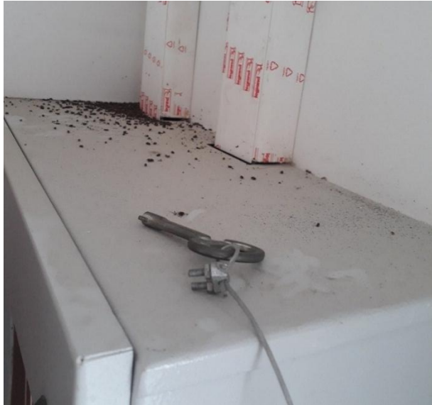
Figura 25. Suciedad sobre el tablero principal
