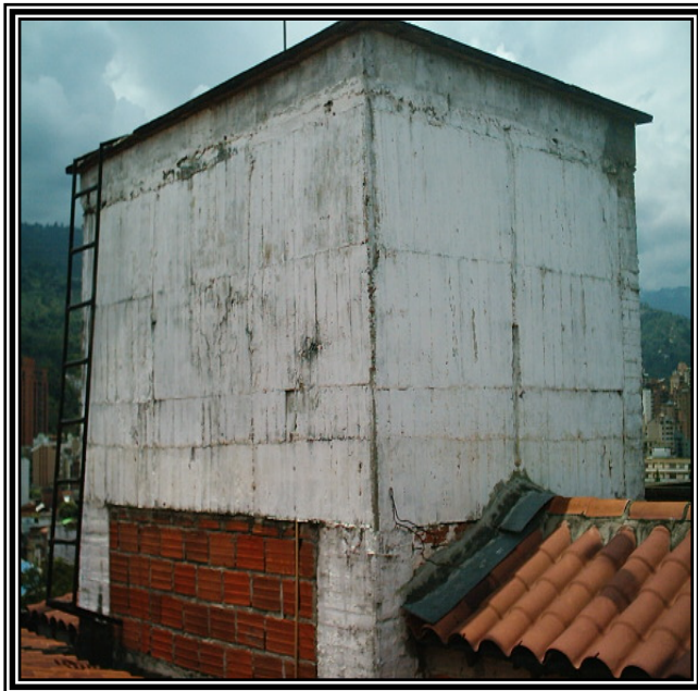
Figura (3.18). Foto Tanque Elevado Casandra.
