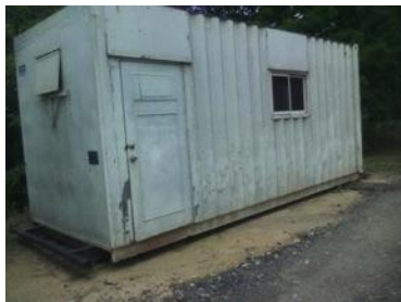
Figura 43. Visita de obra campamento Servipetrol, Campamento desgastado por el uso.
