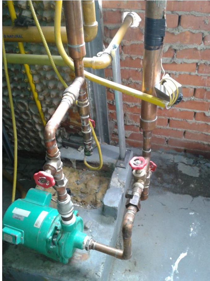
Ilustración 5 Bomba centrífuga Barnes
