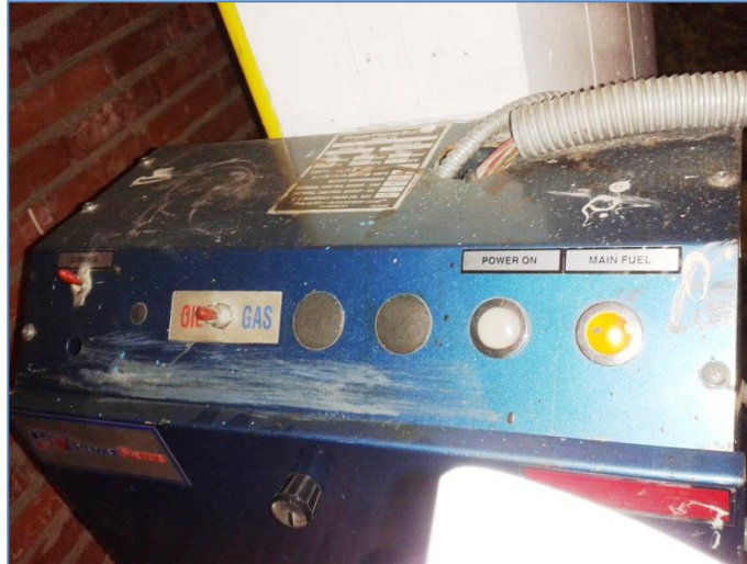
Ilustración 5 Tablero de control caldera
