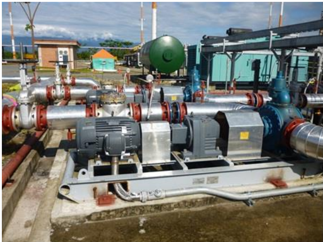
Figura 14. Bombas de Despacho (P-X02A/B)
