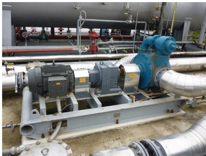
Figura 9. Bombas de transferencia de crudo P-X01A/B
