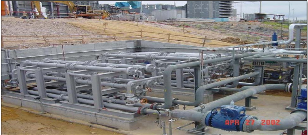
Figura 29. Fotografía de un sistema complejo de acondicionamiento del gas combustible para tratar hasta 90MMscfd de gas usado por una planta de energía de utilidad.
