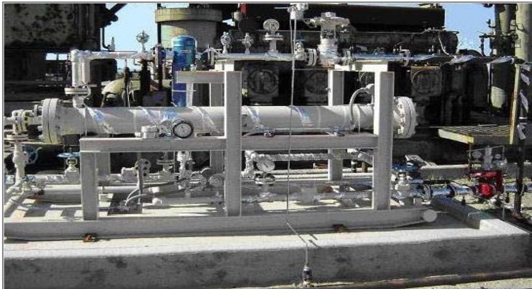
Figura 26b: bloque de unidad de acondicionamiento
