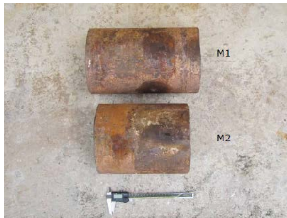
Figura 2. Dos secciones de tubería afectada por corrosión tipo picadura.
