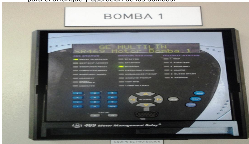
Fig.68 Tablero de control eléctrico del motor en las bombas BJ1-BJ2
