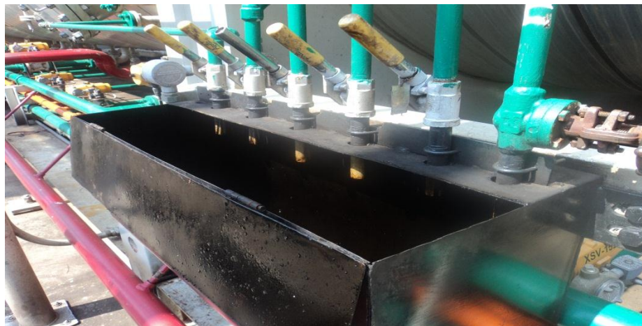
Fig.52 Toma muestras al retirar la tapa de recubrimiento
