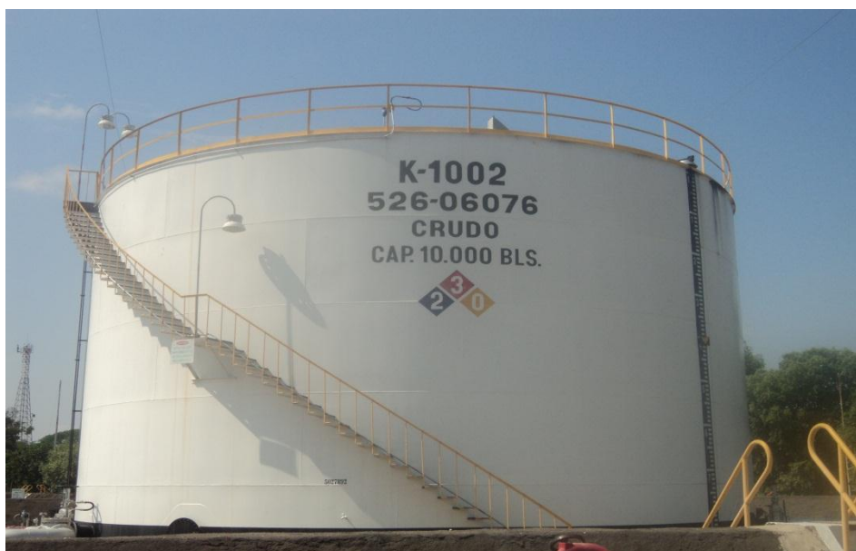
Fig.42 Tanque de reposo K-1002
