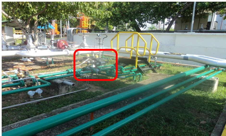
Fig.30 Sistema de inyección de agua tratadores 3 y 4. Se controla desde el cuarto de control por medio de válvulas automáticas remotas.
