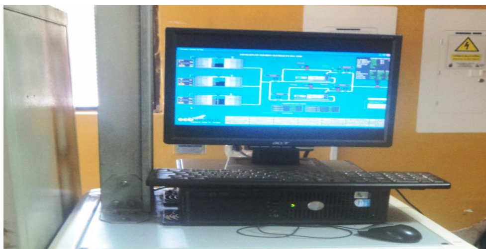
Fig. 72 Computador ubicado en la caseta de la estación de bombeo
