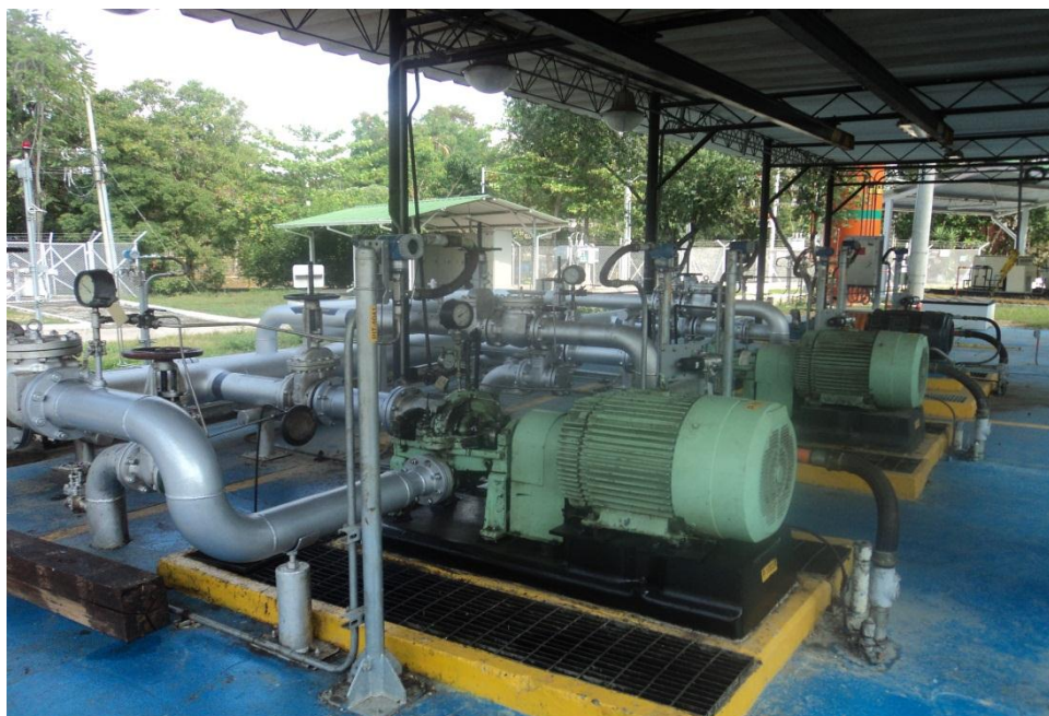
Fig.53 Bombas de trasiego 1002A, 1002B y 1002C
