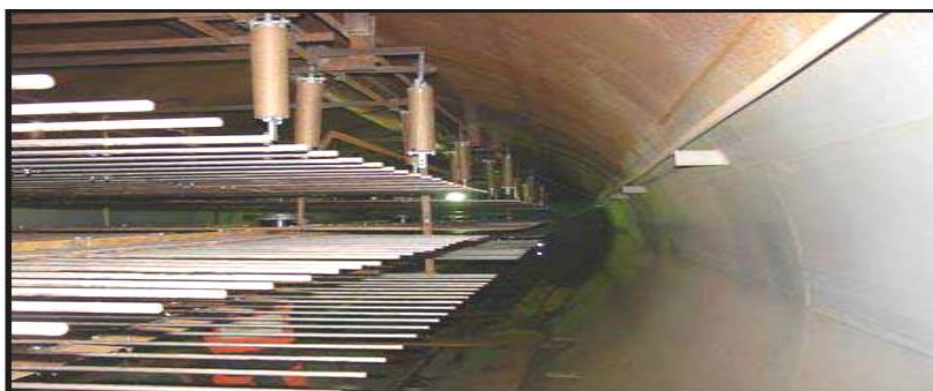
Fig.37 Parrillas inductoras de la corriente eléctrica dentro del tratador
