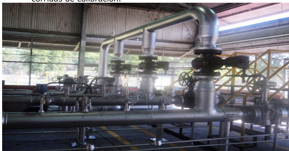
Fig.69 Válvulas de bloqueo y purga
