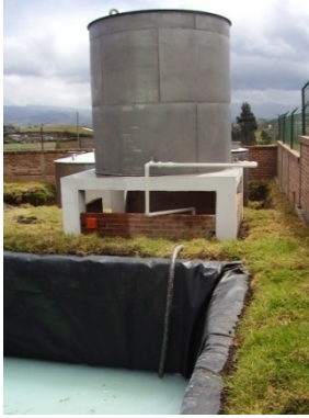
Figura 11. Tanque de igualación y control de caudal
