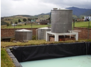
Figura 13. Sedimentador final, Biorreactor, Tanque de igualación y control de caudal
