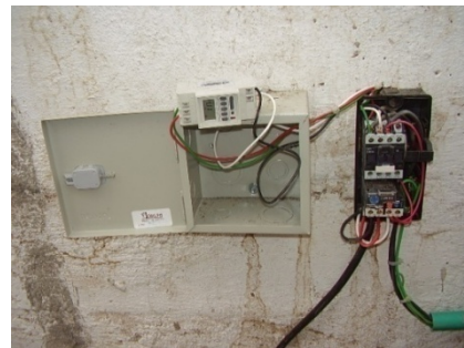
Figura 16. Temporizador y arreglo eléctrico de la Motobomba de reciclo
