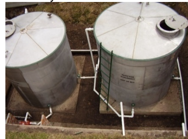
Figura 14. Tanques sedimentador final y Biorreactor
