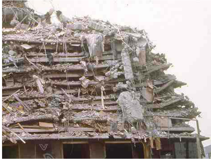
FIGURA 8. EJEMPLO DE COLAPSO POR ERRORES EN CONSTRUCCIÓN.
