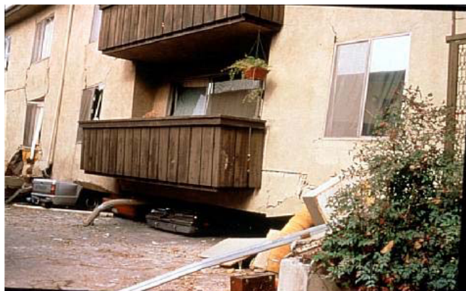
FIGURA 22. COLAPSO DE EDIFICIO CON PISO FLEXIBLE PARA PARQUEO.
