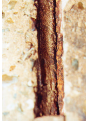
FIGURA 67. EJEMPLO DE FISURAS POR CORROSIÓN.
