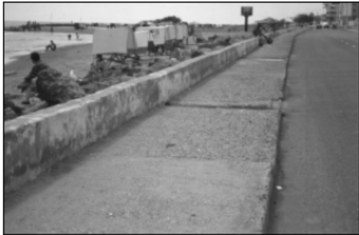
FIGURA 70. ASPECTO DE UN CONCRETO DETERIORADO POR EXPANSION DEBIDA AL ATAQUE DE SULFATO.
