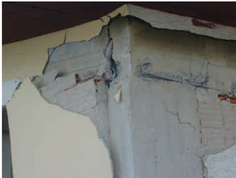
FIGURA 11. DEFICIENTE DETALLADO DEL REFUERZO, FALTA DE ANCLAJE Y DE ADHERENCIA.
