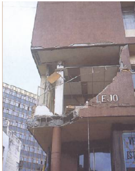
FIGURA 79. LOS MUROS Y LAS FACHADAS NO TIENEN LA ADECUADA RELACIÓN CON EL COMPORTAMIENTO DE LA ESTRUCTURA.
