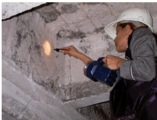
FIGURA 32. LOCALIZACIÓN Y DELINEAMIENTO DE FISURAS.
