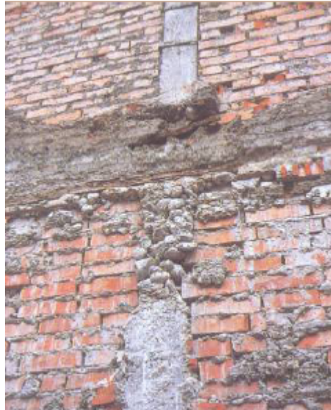
FIGURA 7. EJEMPLO DE FALTA DE CONTROL EN EL MANEJO DE LA MEZCLA.
