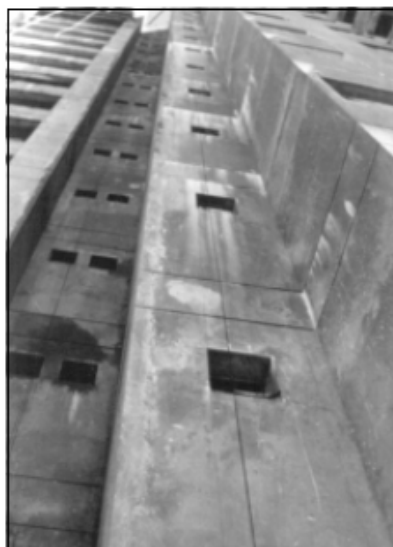
FIGURA 88. CONCRETO MANCHADO POR CONTAMINACION DE LA SUPERFICIE.
