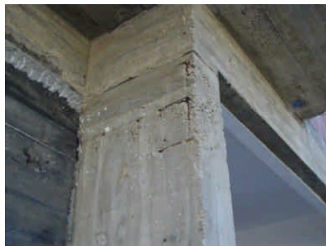
FIGURA 10. ESTRUCTURA EN CONSTRUCCIÓN DONDE SE DETECTA LA FALTA DE RECUBRIMIENTO.
