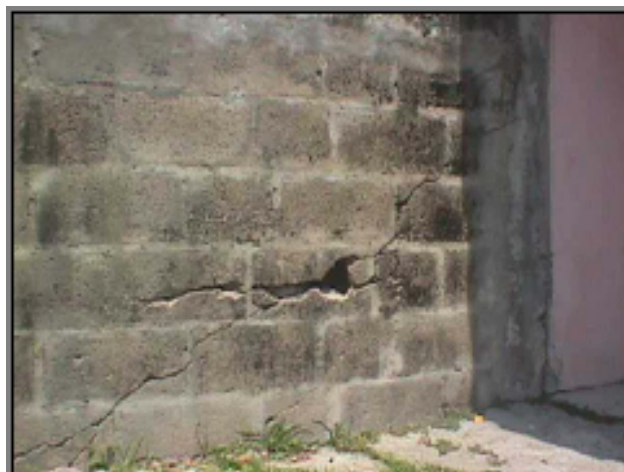
FIGURA 45. EJEMPLOS DE FISURAS EN MUROS DE FACHADAS.
