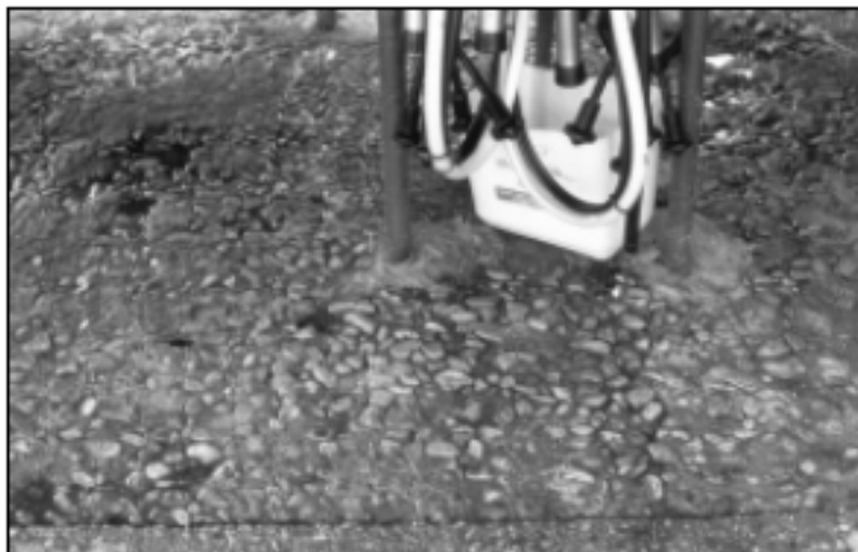
FIGURA 89. ASPECTO DE LA SUPERFICIE DE UN CONCRETO LIXIVIADO.
