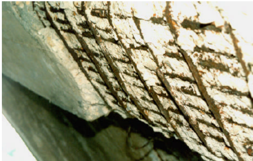
FIGURA 68. EJEMPLO DE ACERO AL DESCUBIERTO.
