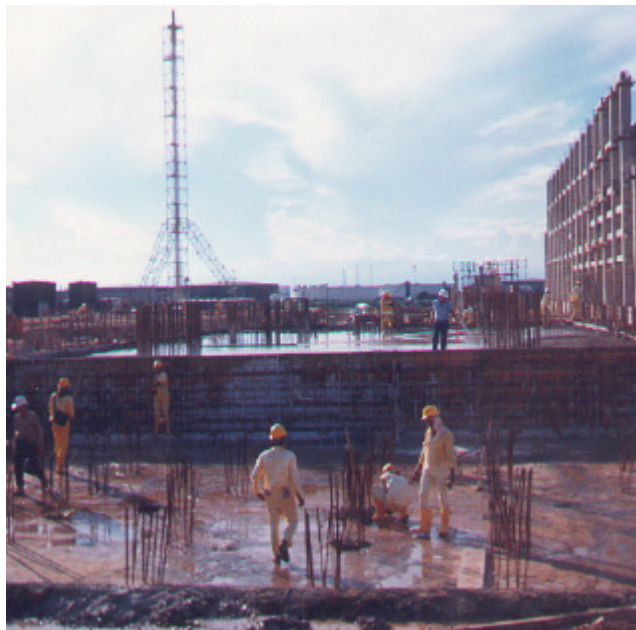
FIGURA 44. FISURAS POR ORIGEN TÉRMICO.
