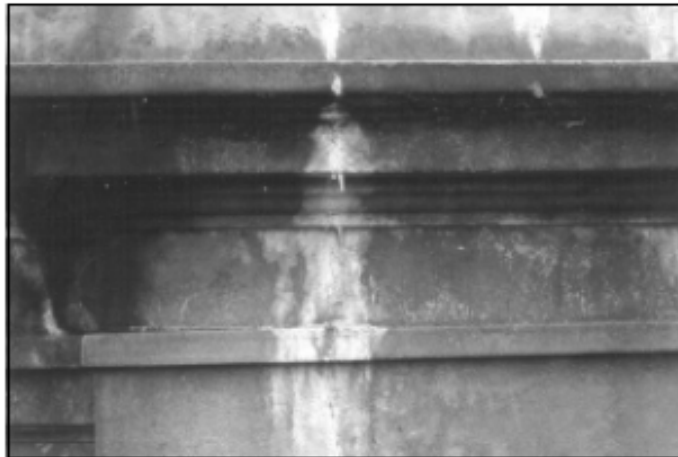
FIGURA 91. EFLORESCENCIA Y MANCHADO DE UNA SUPERFICIE DE CONCRETO POR CARBONATACION.
