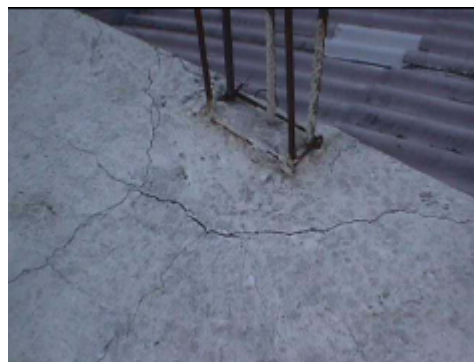
FIGURA 49. EJEMPLO DE FISURAS EN NUDOS.
