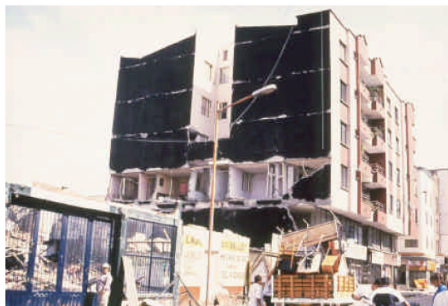
Figura 27. CAÍDA DE MUROS DE FACHADA POR FLEXIBILIDAD DE LA ESTRUCTURA.
