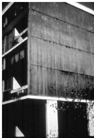
FIGURA 24. INTERRUPCIÓN DE MURO ESTRUCTURAL EN LA PLANTA BAJA.
