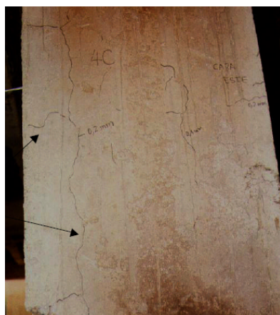
FIGURA 66. EJEMPLO DE LOCALIZACIÓN DE FISURAS POR LA PRESENCIA DEL FUEGO.
