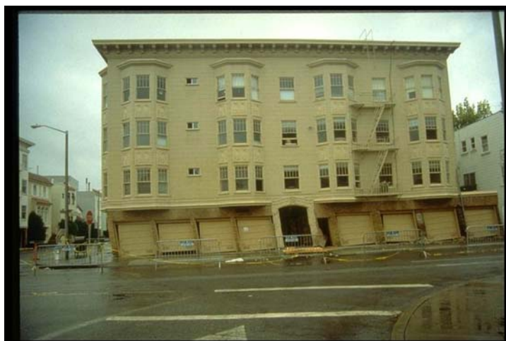
FIGURA 21. FALLA EN PLANTA BAJA POR PISO SUAVE.
