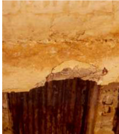
FIGURA 65. ACCIÓN DEL FUEGO SOBRE EL CONCRETO.
