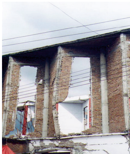
FIGURA 84. EJEMPLO DE FALLA A CARGA AXIAL (COLUMNA ESBELTA).
