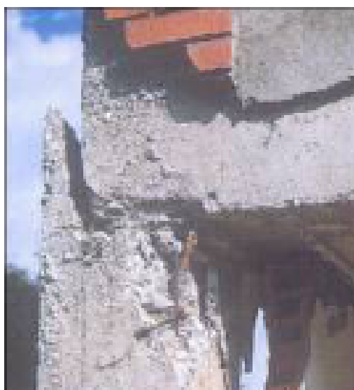
FIGURA 26. EJEMPLOS DE DAÑOS EN DIAFRAGMAS.
