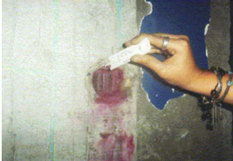
FIGURA 124. LA PRUEBA CON LA FENOLFTALEINA SE REALIZA EN LAS COLUMNAS EN LAS QUE SE DESCUBRE EL ACERO. LA FOTOGRAFÍA MUESTRA UNA COLUMNA CUYA PROFUNDIDAD MÁXIMA DE CARBONATACIÓN ES DE 1.2CM.
