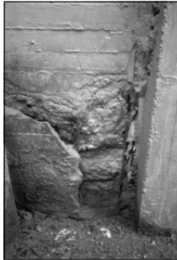
FIGURA 72. EJEMPLO DE LA ACCIÓN DE LOS ÁLCALI – AGREGADOS.
