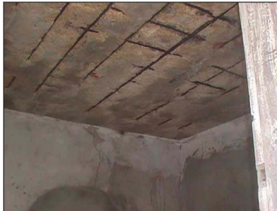
FIGURA 74. EJEMPLO DE CORROSIÓN.
