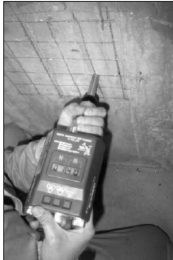
FIGURA 101. ESTIMACIÓN DE LA RESISTENCIA APROXIMADA DEL CONCRETO Y SU UNIFORMIDAD, MEDIANTE EL USO DE UN ESCLERÓMETRO DIGITAL.
