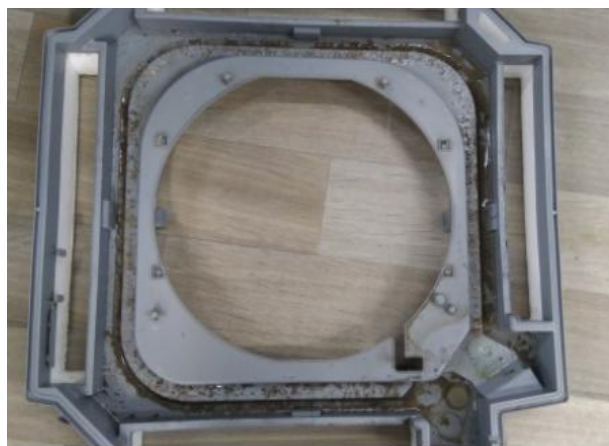
Imagen 35. Bandeja de condensado equipo tipo cassette.
