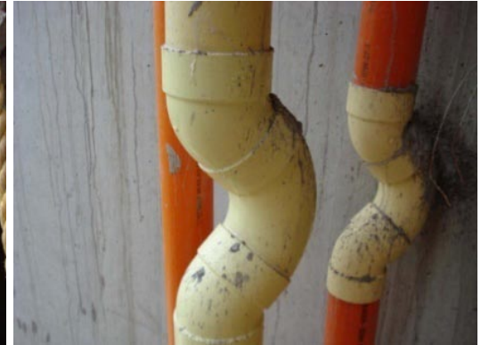
Quebres a bajantes
