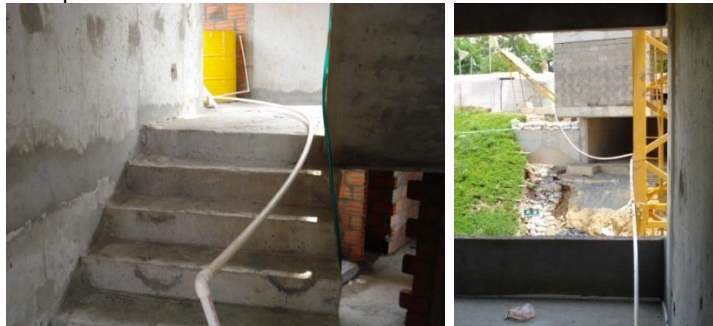
Figura 217. Red hidráulica provisional
