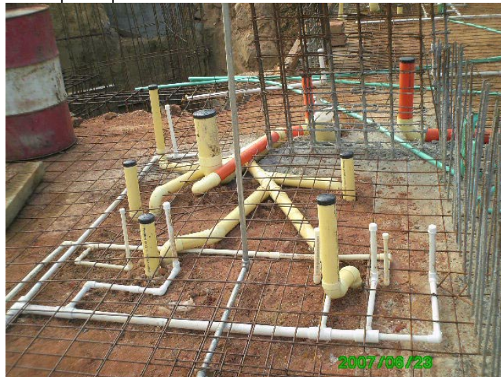
Figura 24. Instalación en un primer piso
