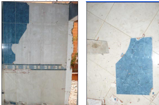
Figura 35. Baldosa quebrada al intentar su recuperación
