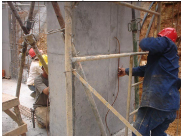
Figura 131. Marcación de altura de referencia con ayuda de una manguera de nivel
