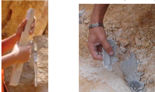
Figura 73. Apariencia del cemento expansivo en los orificios llenados y en la superficie de falla
