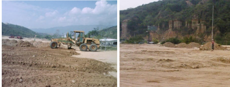
Figura 270. Nivelación con ayuda de moto niveladora y toma de niveles de topografía
