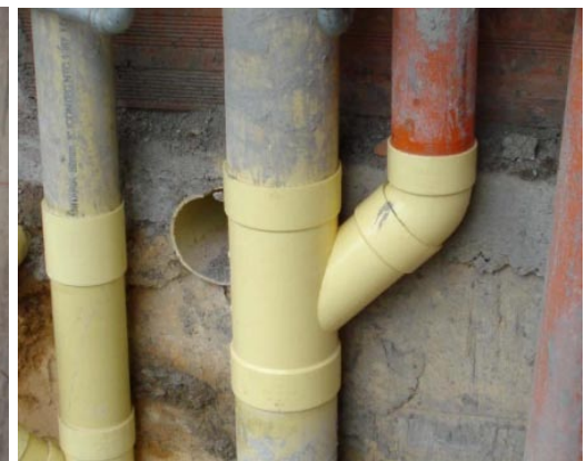
Conexión inferior de ventilación
