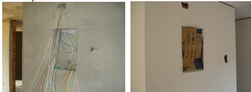
Figura 227. Cobertura de cajas
