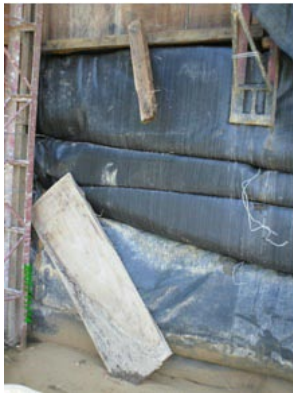
Falla de alineamiento
