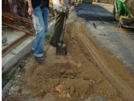
Figura 286. Problemas de mala compactación en la base granular
