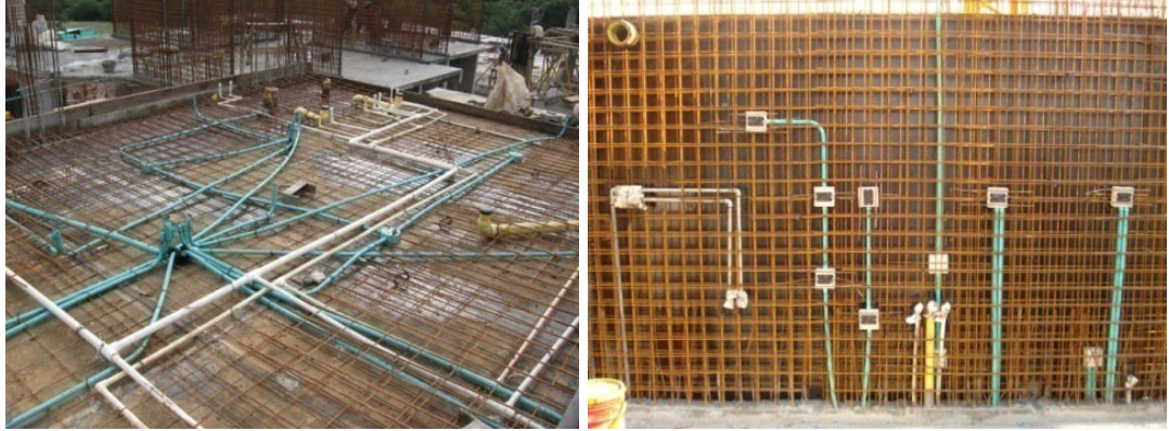
Figura 212. Instalaciones internas en estructura túnel
