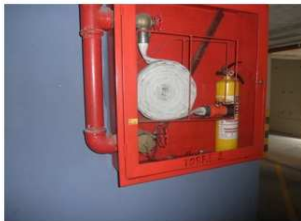
gabinete contra incendios
