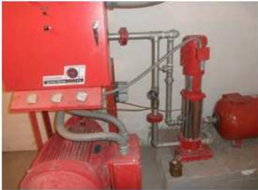
sistema de bombas
