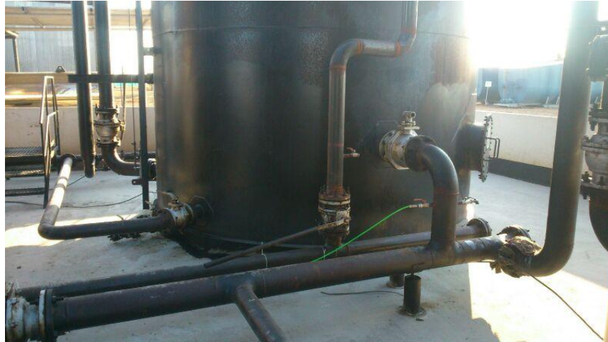
Figura 10. Instalación punto de rompedor inverso a la entrada de los skimming tank 3 y 4
