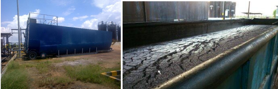
Figura 7. Tanques de deshidratación de flocs y de preparación para despacho para disposición final
