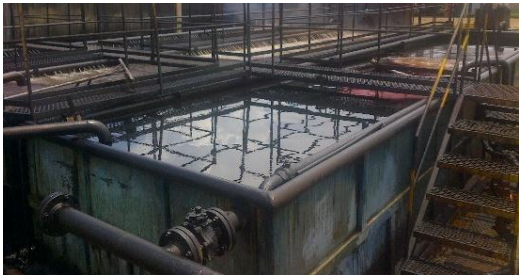
Figura 4. Equipos del sistema de tratamiento de aguas (a) Catch tank 1 (b) caja API
