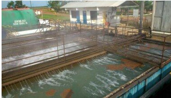
Figura 5. Tren de catch tanks para tratamiento de aguas.
