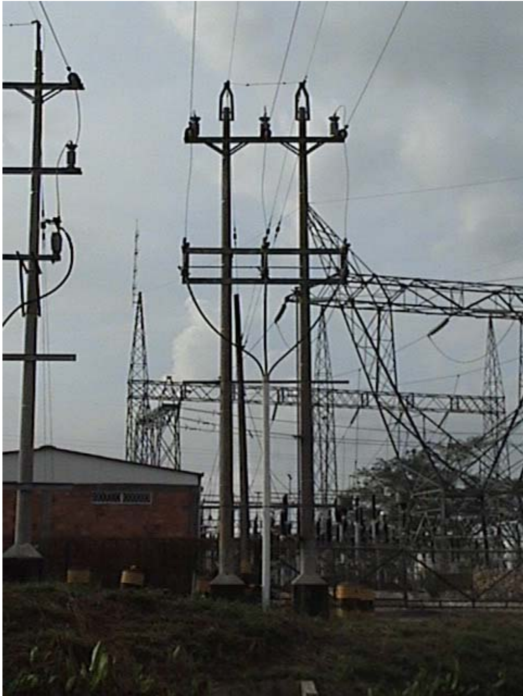
Figura C. 1. Estructura RT-E01, salida de la línea Norte
