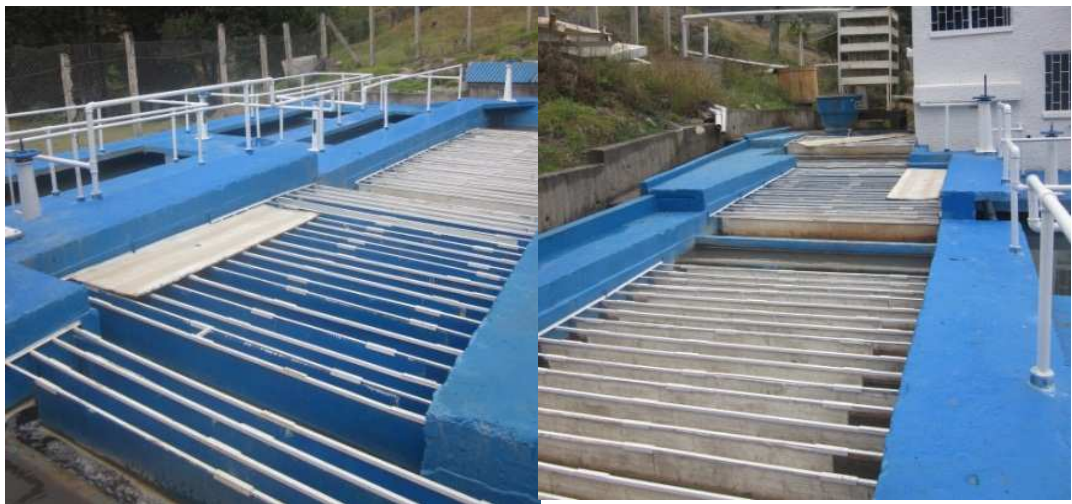
Figura 14. Unidad de floculación
