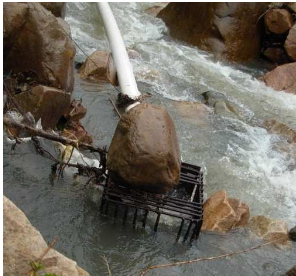
Figura 6. Bocatoma de Fondo
