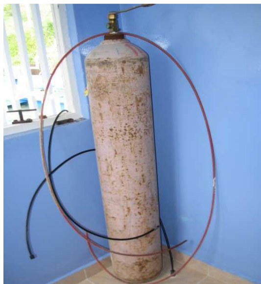
Figura 19. Unidad de Desinfección. Pipeta de cloro gaseoso
