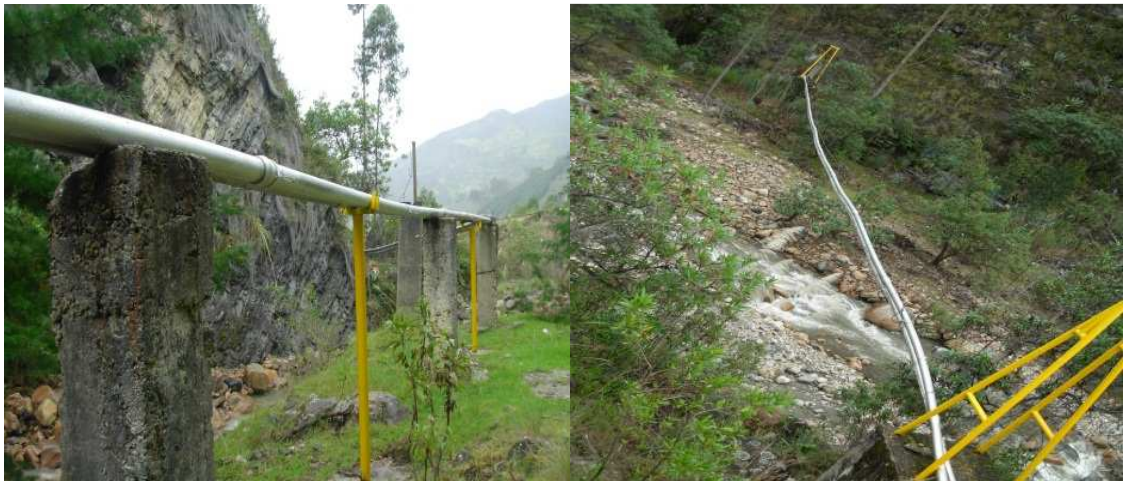
Figura 8. Tubería de conducción de agua a la planta
