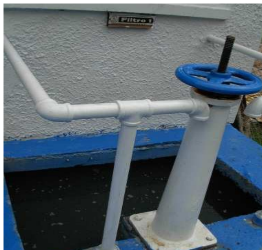
Figura 18. Unidad de filtración.
