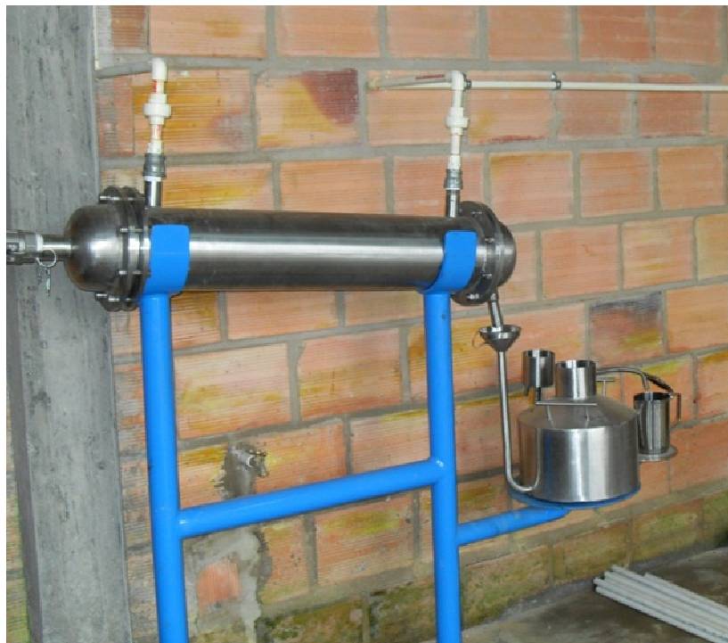
Figura 23. Condensador de vapor de haz de tubos instalado en el municipio de Sucre (Santander). Foto: Carlos A. Cárdenas, Diciembre de 2010.
