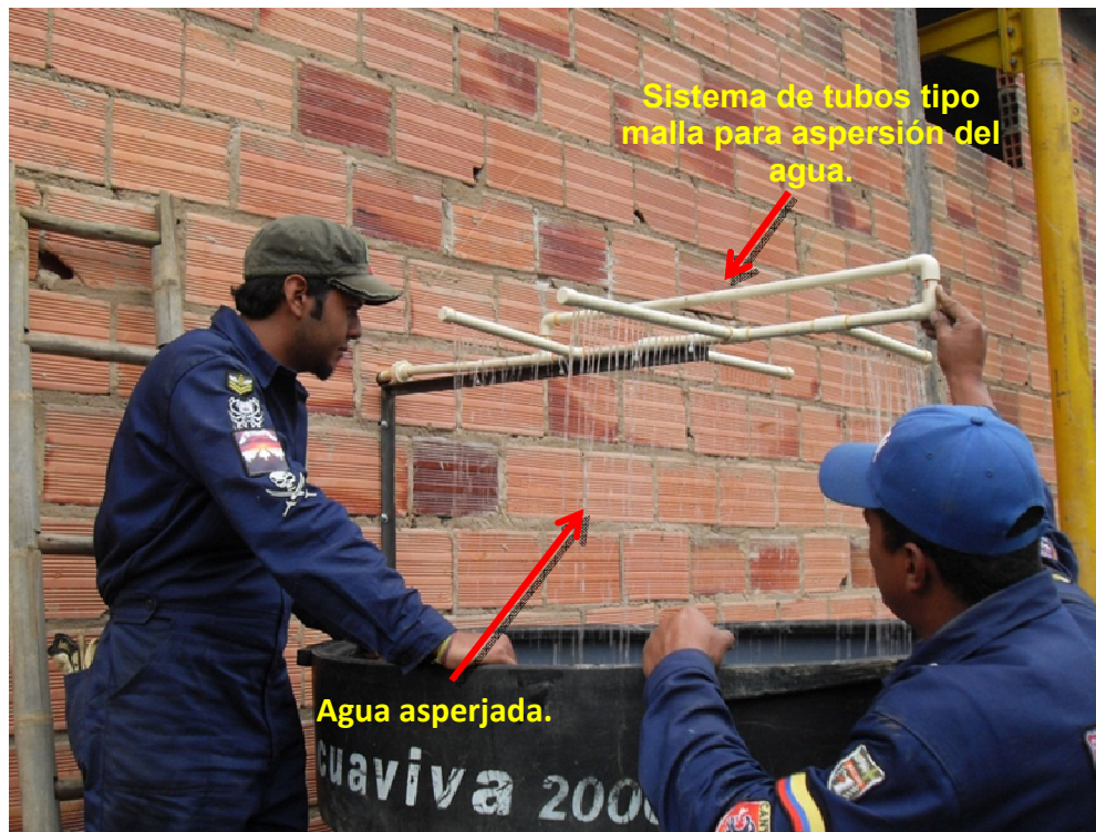
Figura 24. Sistema de refrigeración instalado en el municipio de Sucre (Santander). Noviembre de 2010.
