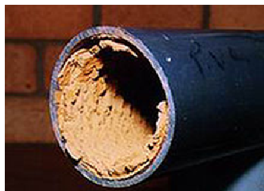
Figura 17. Problemas de obstrucción en la tubería.
