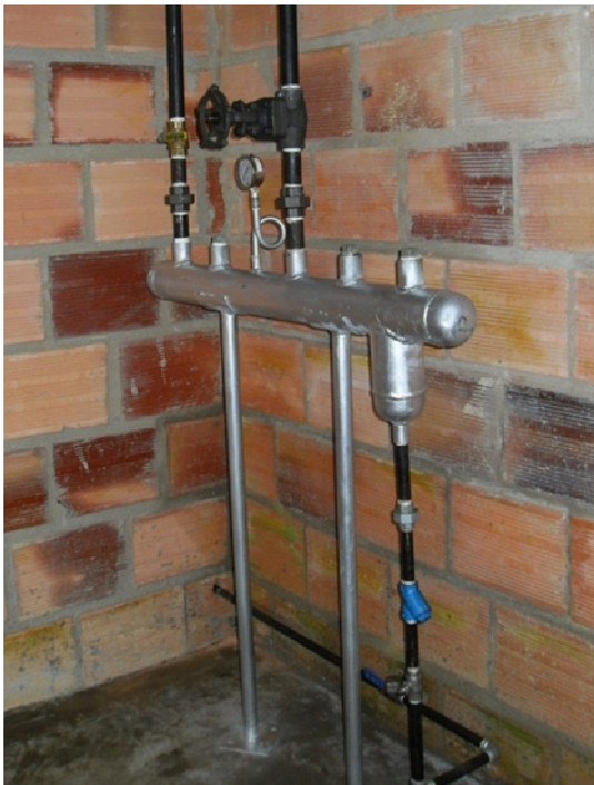
Figura 22. Distribuidor de vapor instalado en el municipio de Sucre (Santander). Foto: Víctor Pérez, Noviembre de 2010.
