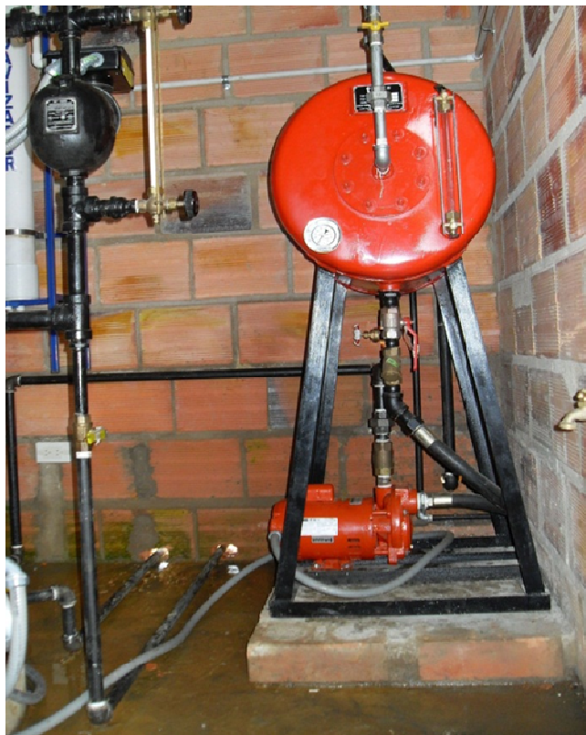
Figura 18. Tanque de condensados instalado en el municipio de Sucre (Santander). Foto: Carlos A. Cárdenas, Noviembre de 2010.
