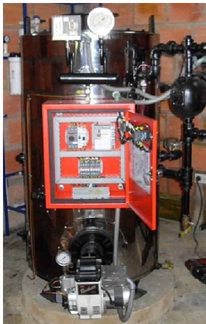
Figura 2. Generador de vapor marca Tecnik, instalado en el municipio de Sucre (Santander). Foto: Víctor Pérez, Octubre 2010.
