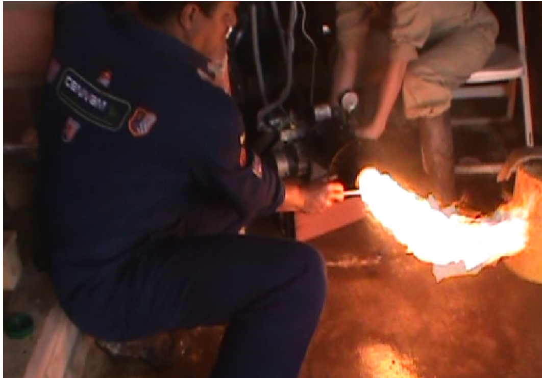
Figura 20. Pruebas de encendido quemador de ACPM instalado en el municipio de Sucre (Santander). Foto: Carlos A. Cárdenas, Noviembre de 2010.
