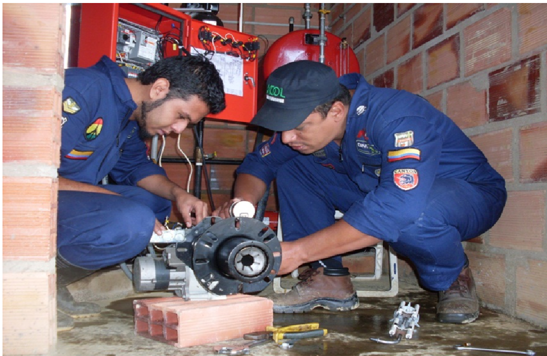
Figura 19. Reparaciones realizadas en el quemador de ACPM instalado en el municipio de Sucre (Santander). Noviembre de 2010.
