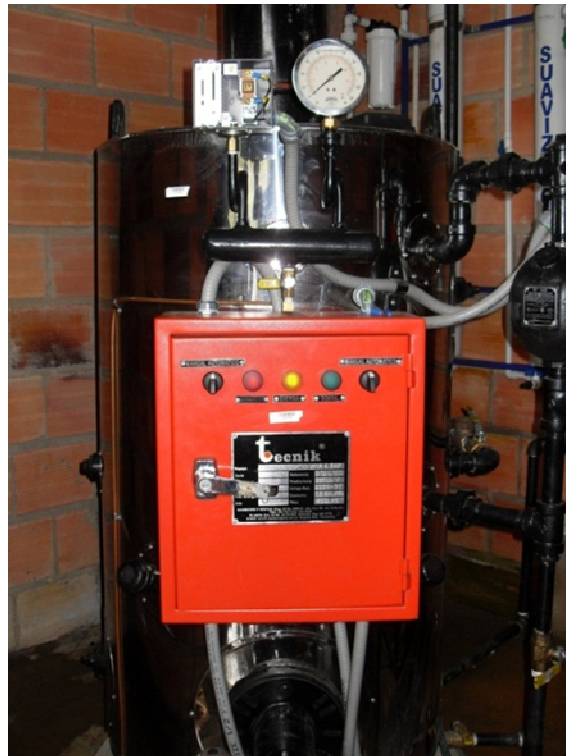
Figura 15. Generador de vapor instalado en el municipio de Sucre (Santander) marca Tecnik de 6 BHP. Foto: Víctor Pérez, Octubre de 2010.
