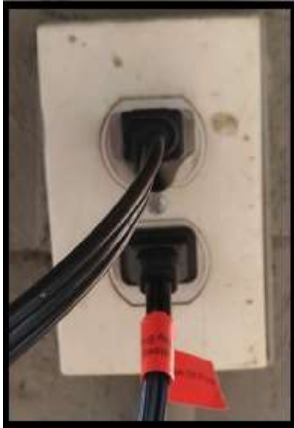
Imagen 33. Conexión External Power a toma corriente.
