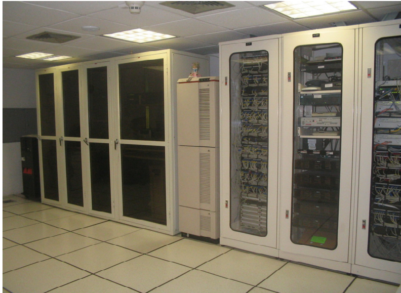
Figura 8. Fotografías del cuarto de equipos y rack del Centro de Cómputo
