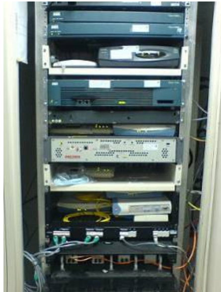
Figura 9. Cableado hecho en el Rack del Centro de computo
