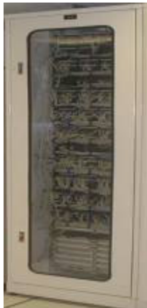
Figura 7. Fotografías del centro de cableado de la red de datos de la Financiera Comultrasan
