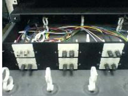
Figura 4. Distribuidor de fibra óptica Centro de Computo.
