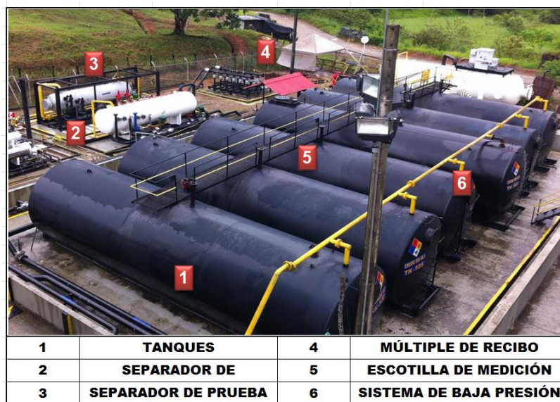
Figura 51. Área tanques horizontales.
