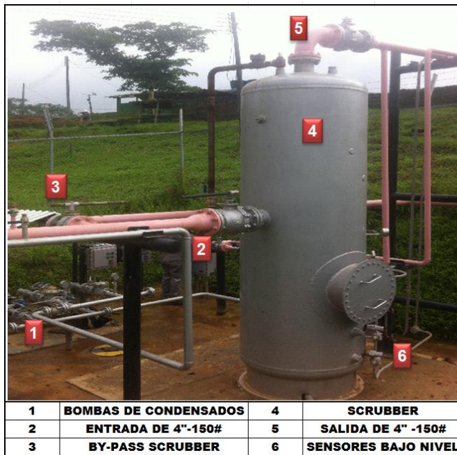
Figura 64. Scrubber Estación Cohembi.
