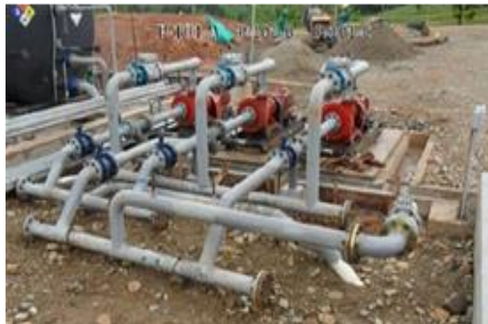
Figura 65. Bombas centrifugas descargadero de agua PIA Cohembi.
