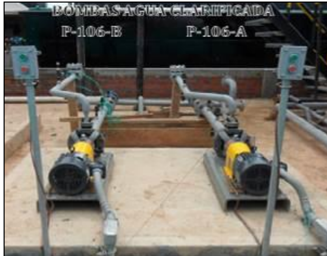
Figura 71. Bombas de agua clarificada
