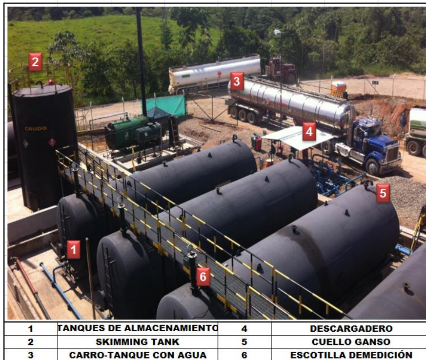
Figura 66. Tanques de almacenamiento de agua PIA Cohembi.
