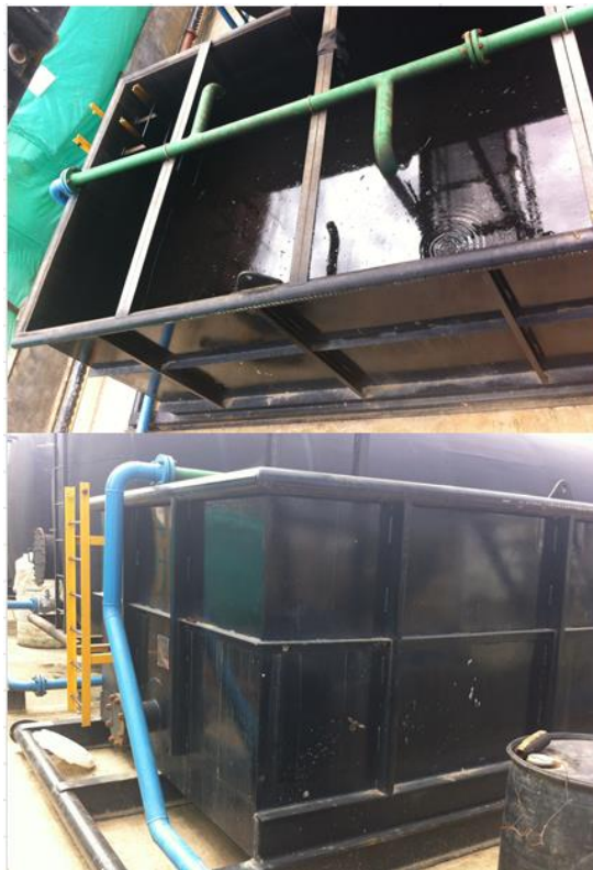
Figura 72. Lecho de secado planta de inyección de agua.
