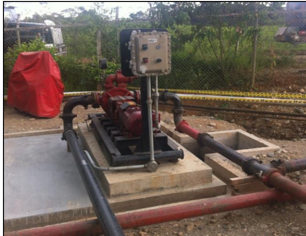
Figura 57. Bomba de recirculación.
