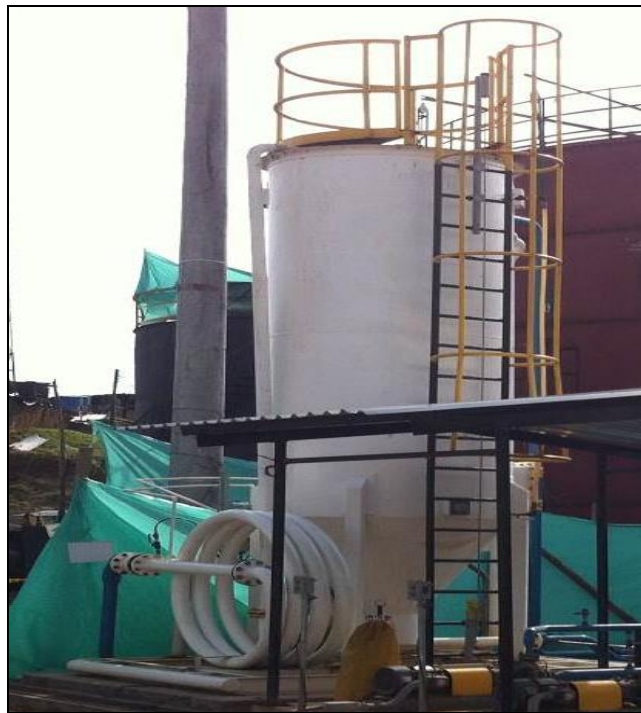
Figura 70. Decantador PIA estación Cohembi 1.
