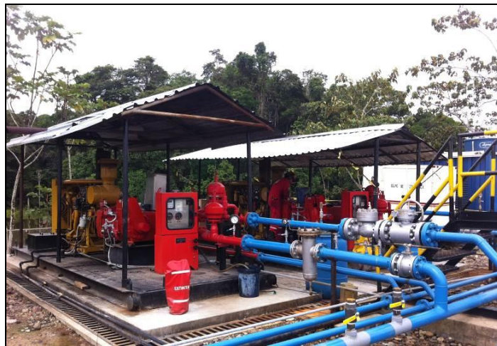
Figura 69. Bombas de inyección PIA estación Cohembi 1.
