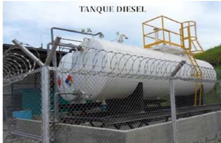
Figura 73. Tanque almacenamiento de combustible.
